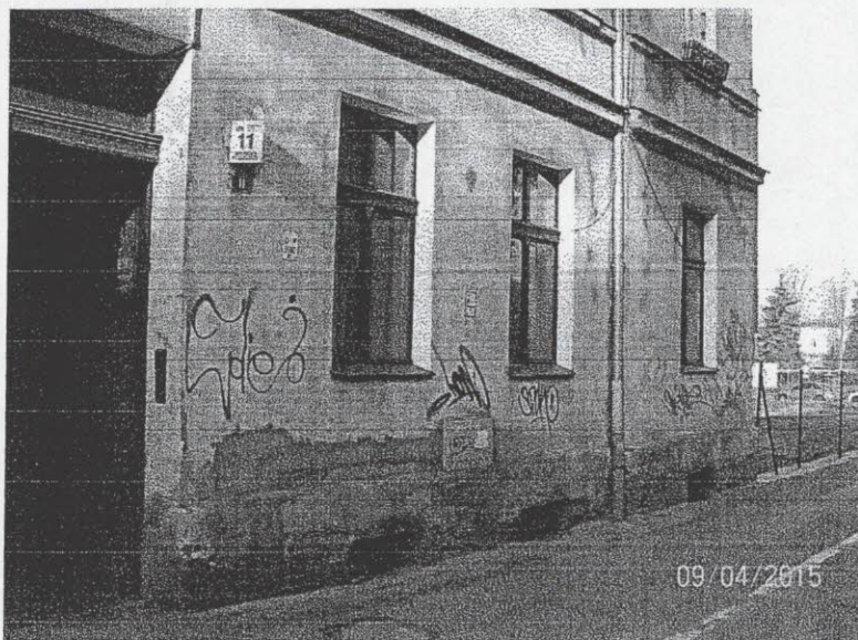
Fot.3. Ubytki tynków zewnętrznych nad poziomem chodnika.
