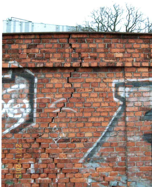
Pęknięcie muru od strony zachodniej.
