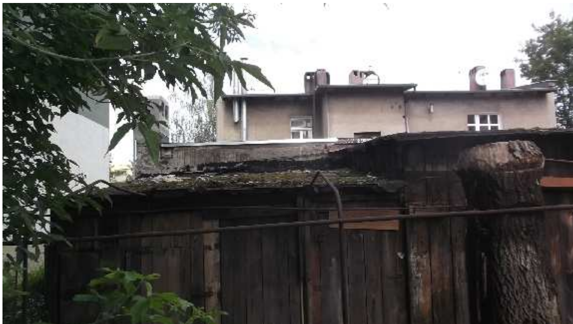
fot. nr 5 Połączenie dachowe budynków – stan techniczny zły. Widoczne ubytki papy oraz pokrycia dachowego.
