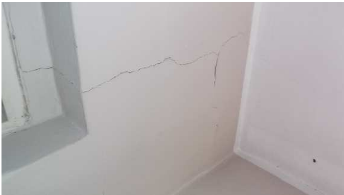
fot. nr 9 strop poziome pęknięcie ściany budynku
