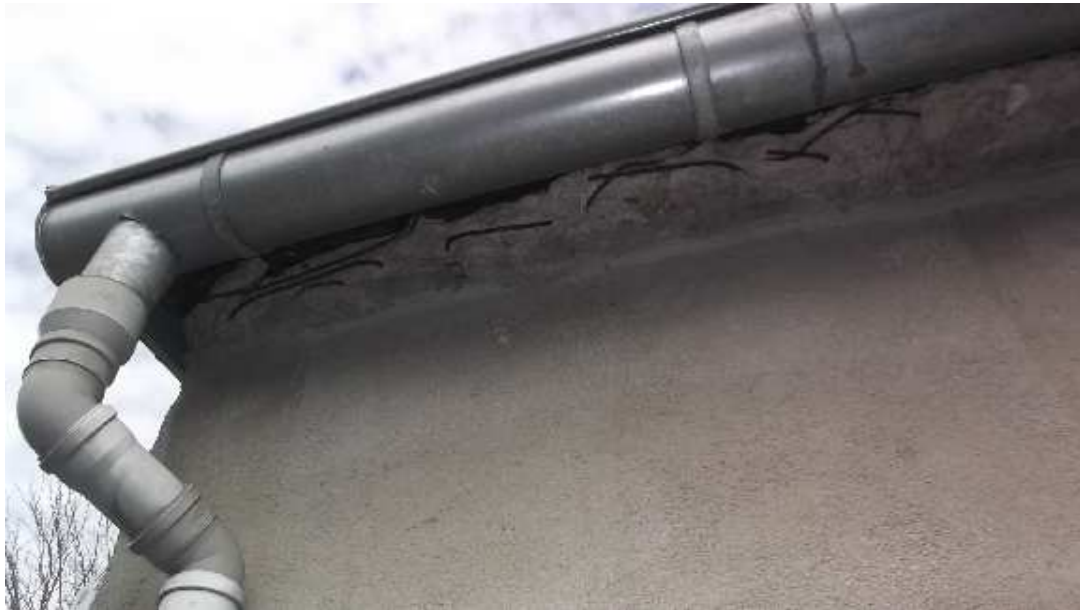
fot. nr 5 Strop betonowy dobudówki – niezabezpieczone pręty zbrojeniowe
