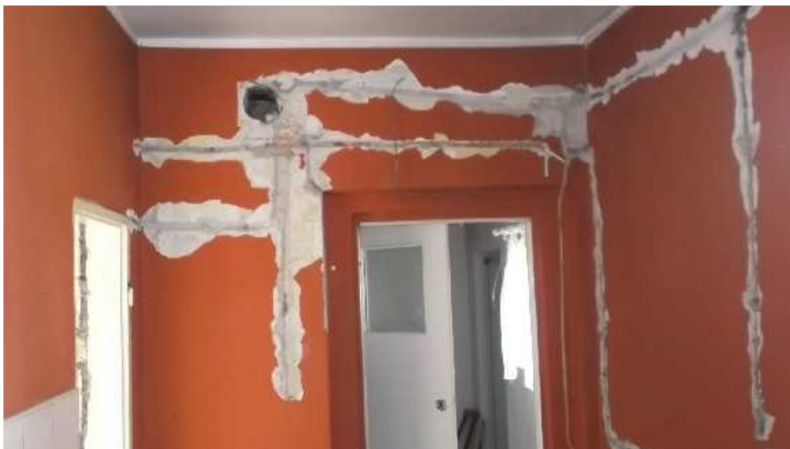
fot. nr 10 Widoczne bruzdy po demontażu instalacji
