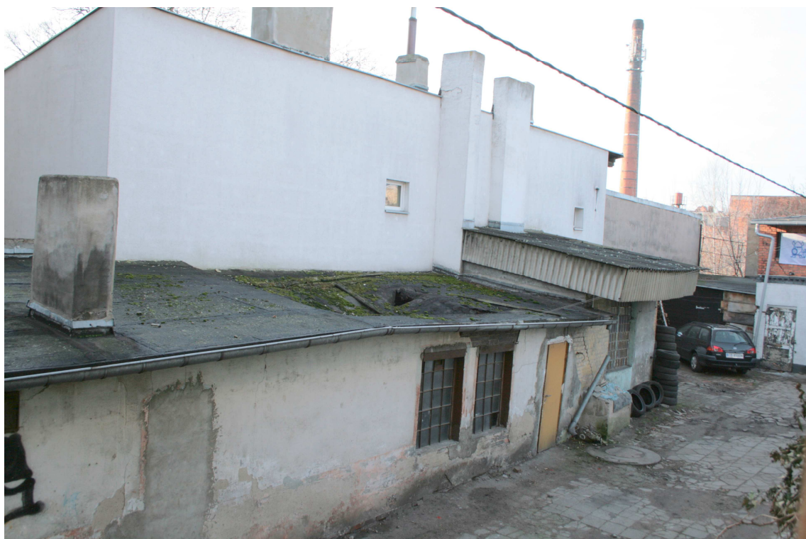
Zawalona część dachu
