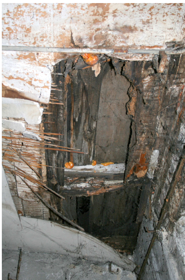
Stan dachu w budynku pokrytym eternitem (wnętrze)
