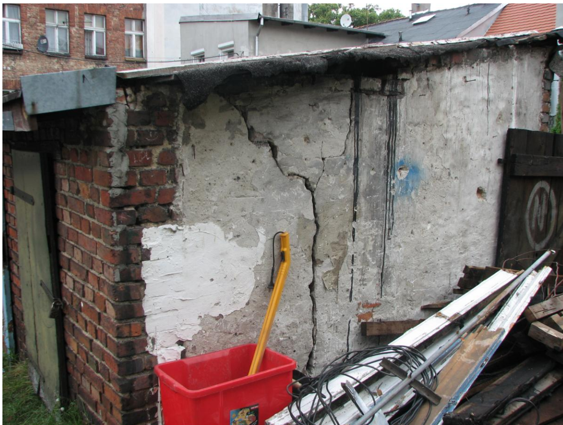
Foto.9 Budynek gospodarczy – popękana ściana boczna
