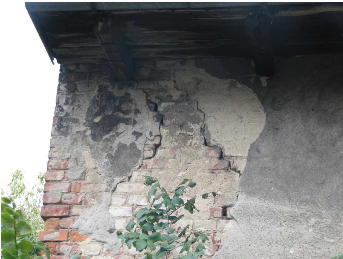
Foto.4 Budynek oficyny – pęknięcia ściany
