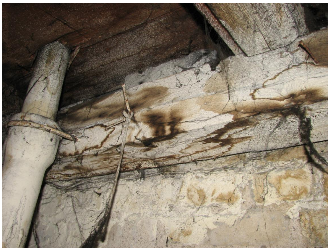
Foto.6 Budynek oficyny – ślady próchnicy konstrukcji dachu
