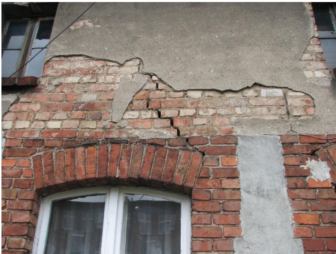
Foto.5 Budynek oficyny – pęknięcia nad nadprożem
