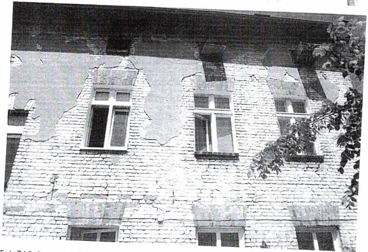
Fot. 7 i 8. Stan spękań ścian piętra budynku 2c od strony podwórza (południowej).
