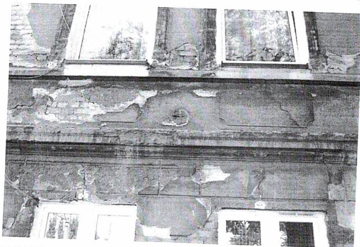
Fot. 3 i 4. Stan spękań ścian budynku 2b w czerwcu 2014 r.
