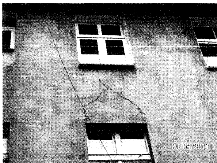
Fot.9. Pęknięcia elewacji tylnej.
