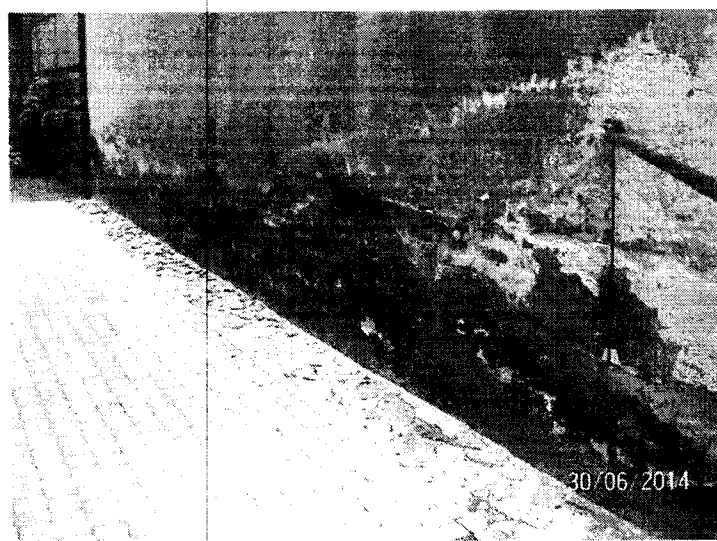
Fot.11. Ubytki tynku i zniszczenia ścian nad poziomem terenu.
