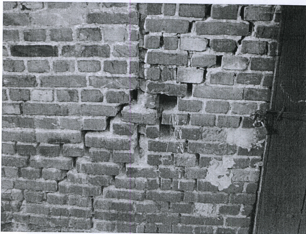
Foto.8 Budynek gospodarczy – popękana ściana od strony frontowej
