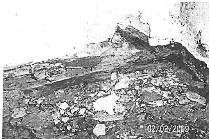
Fot. 2. Spróchniała belka stropowa w pobliżu ściany działowej.
