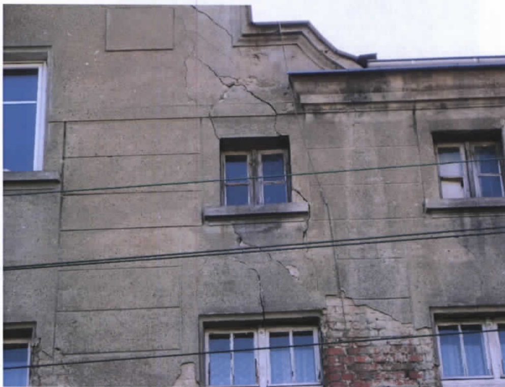
2. Pęknięcia na elewacji frontowej
