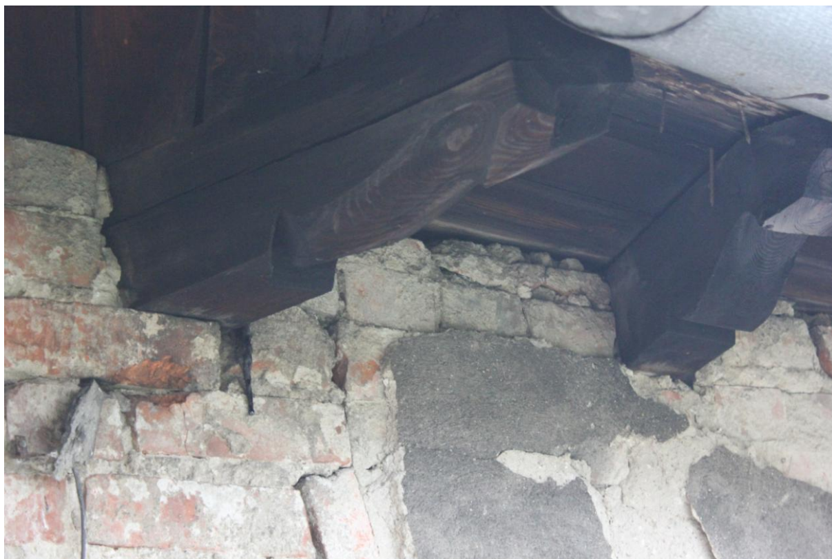
Fot. 3. Ubytki cegieł są miejscami gniazdowania wróbli.
