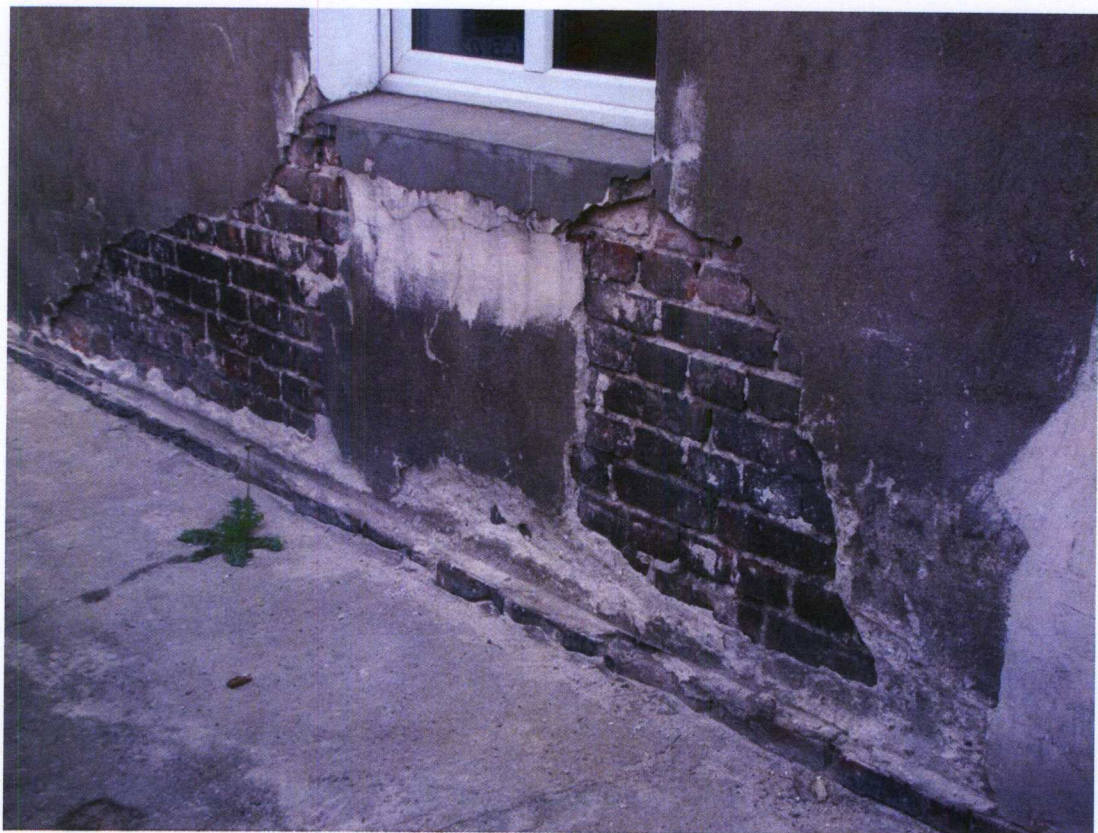
Foto.14 Odpadający tynk na cokole budynku
