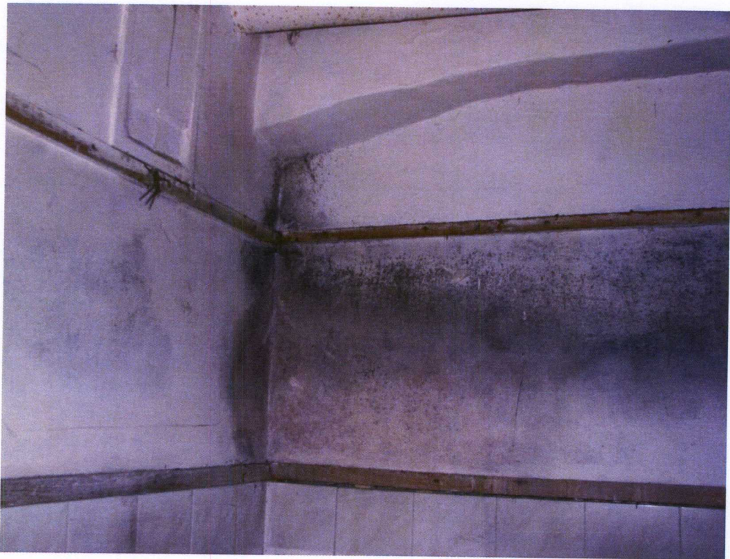
Foto.12 Zagrzybienie ścian w kuchni
