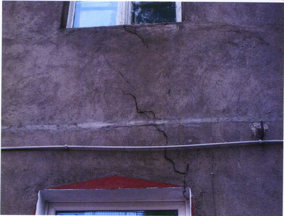
Foto.13 Pęknięcia i rysy na nadprożach okiennych
