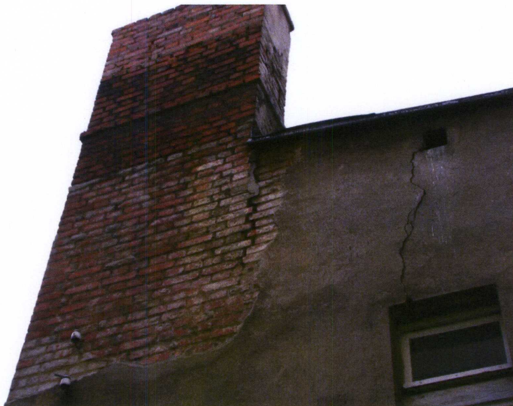
Foto.2 Widok na ścianę szczytowa (przemieszczenie komina względem ściany, rysa na nadprożu okiennym)
