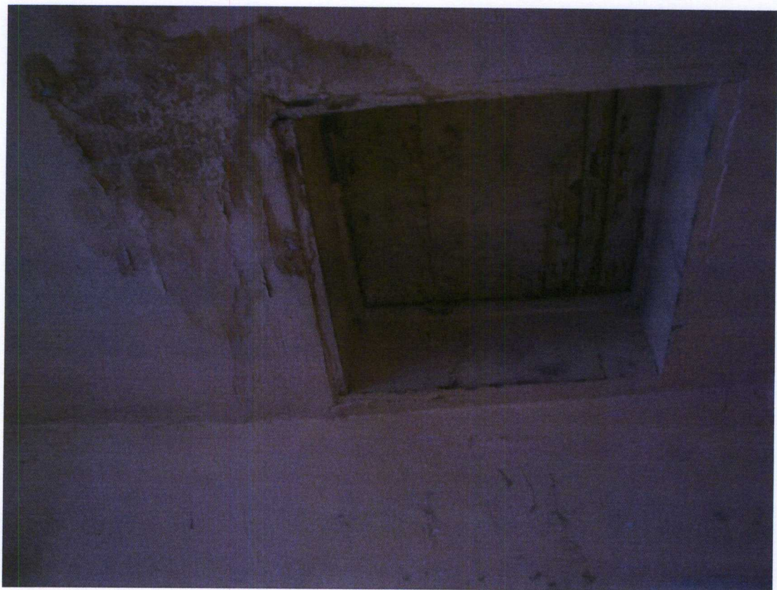
Foto.10 Wyłaz dachowy, ślady po zalaniu
