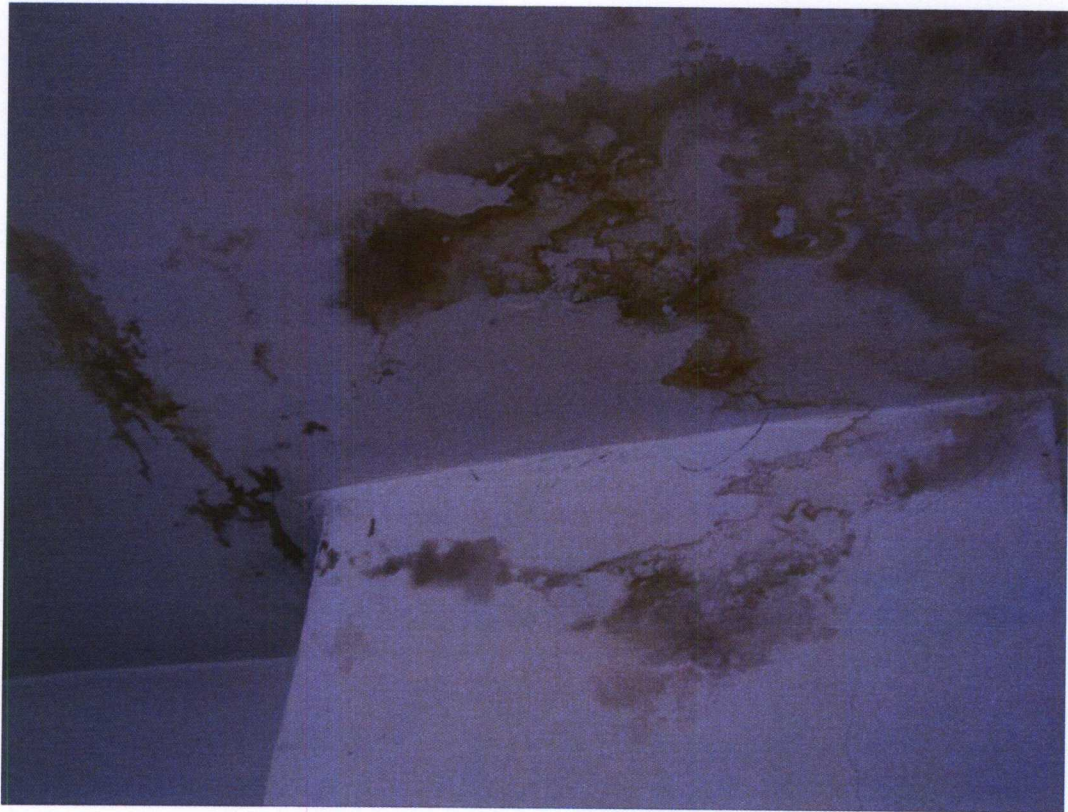
Foto.7 Ślady po zalaniu stropu nad piętrem
