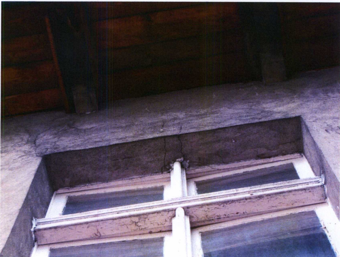
Foto.4 Spróchniałe krokwie i rysa na nadprożu okiennym
