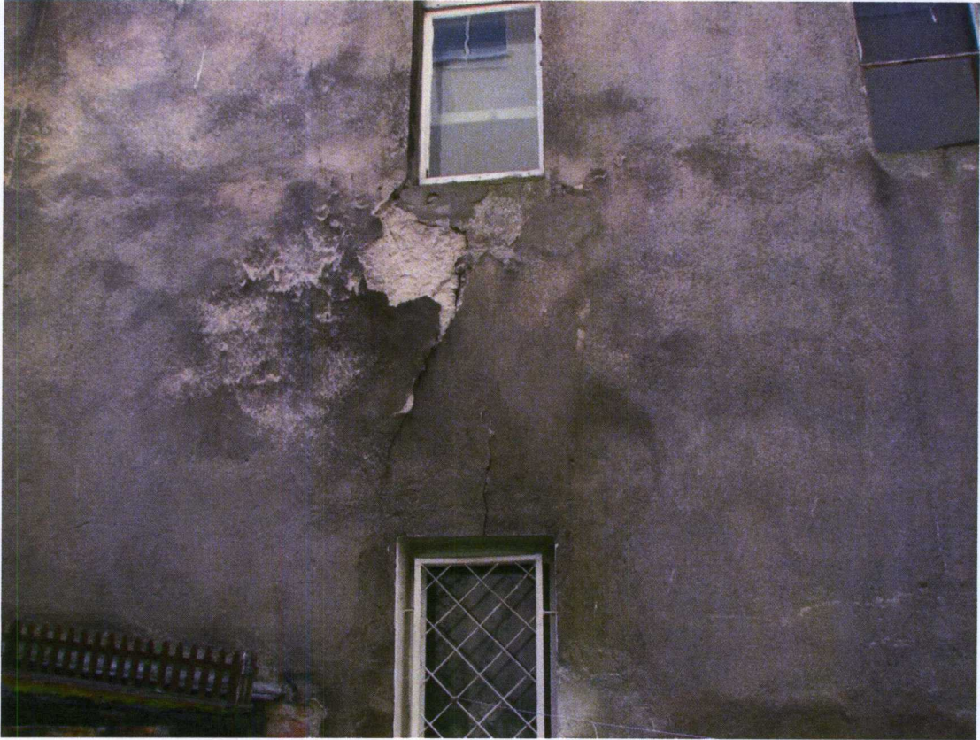
Foto.3 Widok na ścianę szczytowa (pęknięcie ściany i odpadający tynk)
