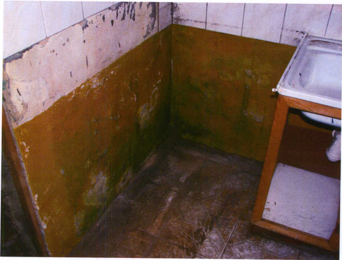
Foto.11 Zagrzybienie ścian w kuchni
