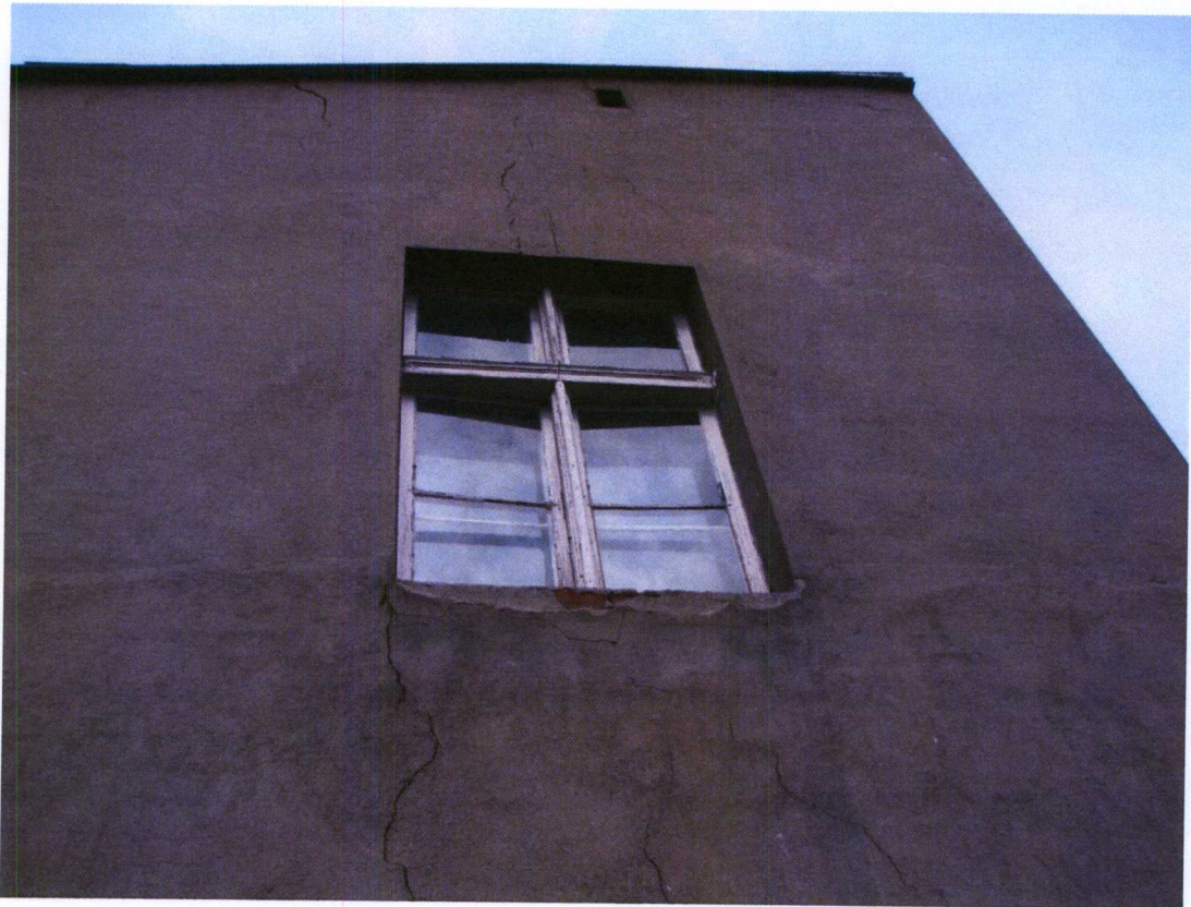
Foto.5 Pęknięcia i rysy na ścianie szczytowej
