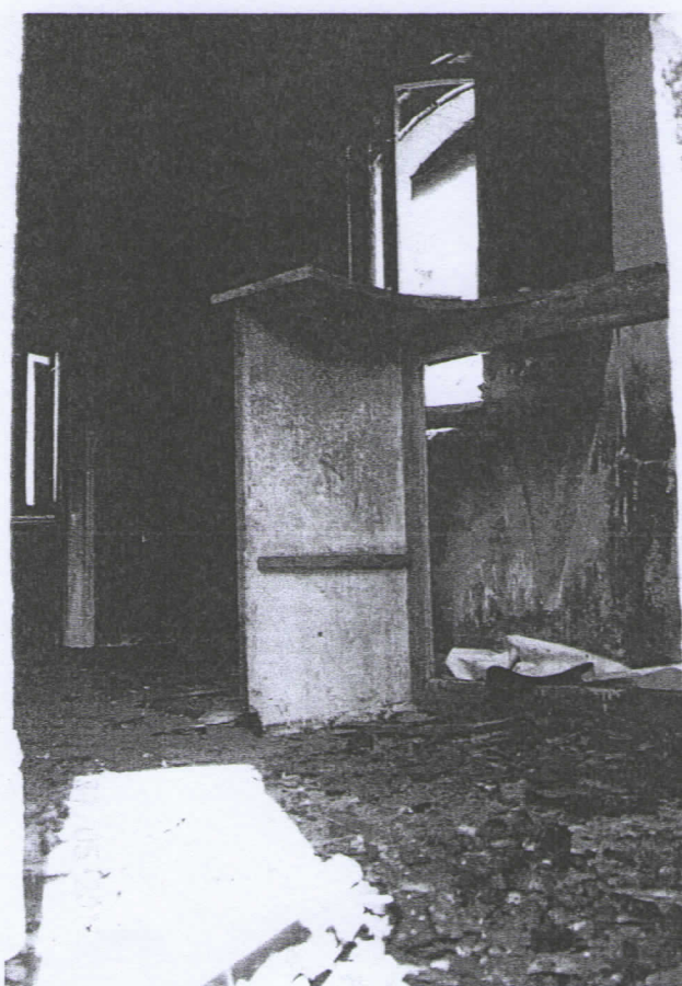
Fot. 6. Zniszczone pomieszczenie we wschodniej części budynku na I piętrze.
