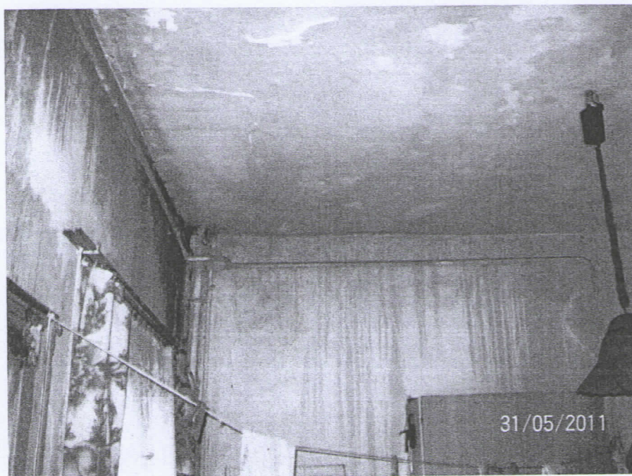
Fot. 8, 9. Zawilgocone powierzchnie ścian i sufitów w pomieszczeniach mieszkalnych parteru.
