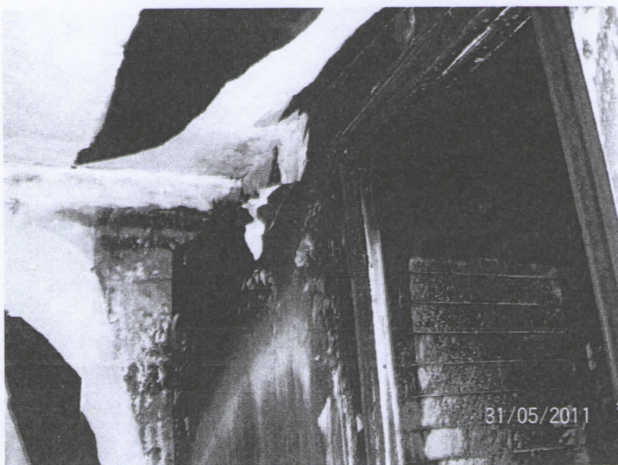
Fot. 7. Osmolone ściany i sufit w środkowej części domu.
