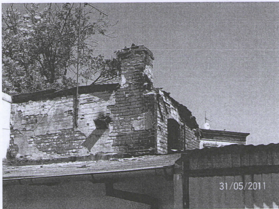
Fot. 4, 5. Spalony szczyt wschodni budynku mieszkalnego.
