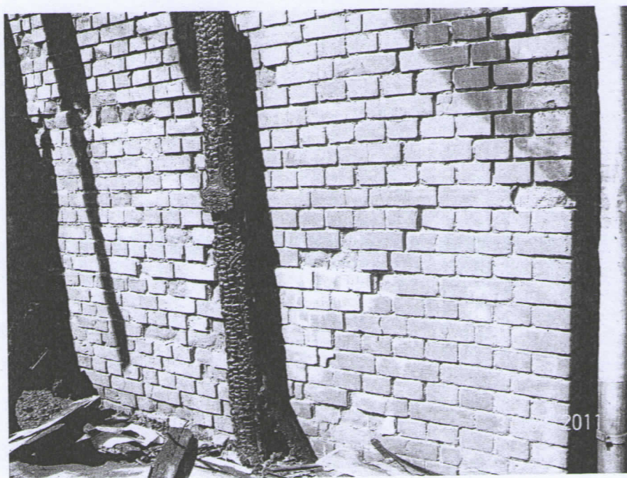
Fot. 10. Zerodowany fragment zewnętrzne ściany szczytowej.
