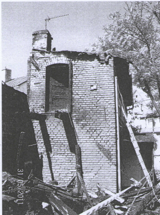
Fot. 3. Elewacja wschodnia budynku mieszkalnego i zniszczone schody wejściowe na I piętro.
