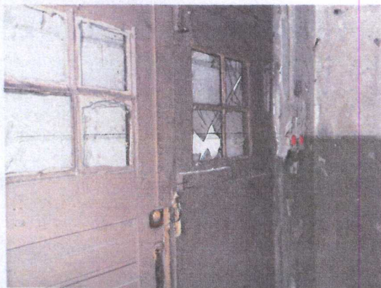
Zniszczona, wypaczona stolarka okienna i drzwiowa
