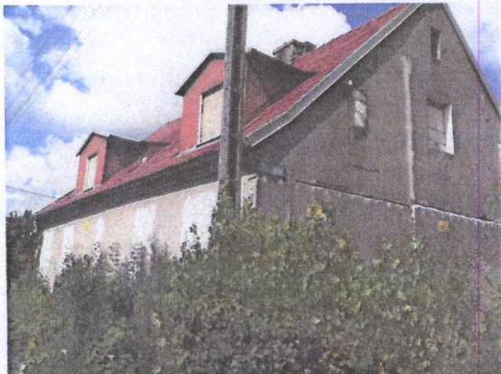
Widoczne niebezpieczne ugięcie dachu
