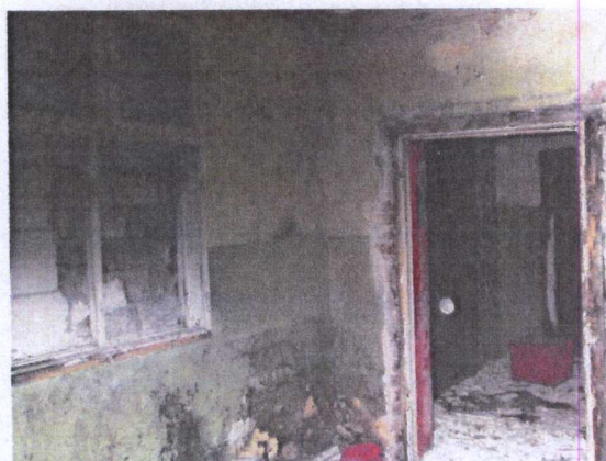
Grzyb na ścianach
