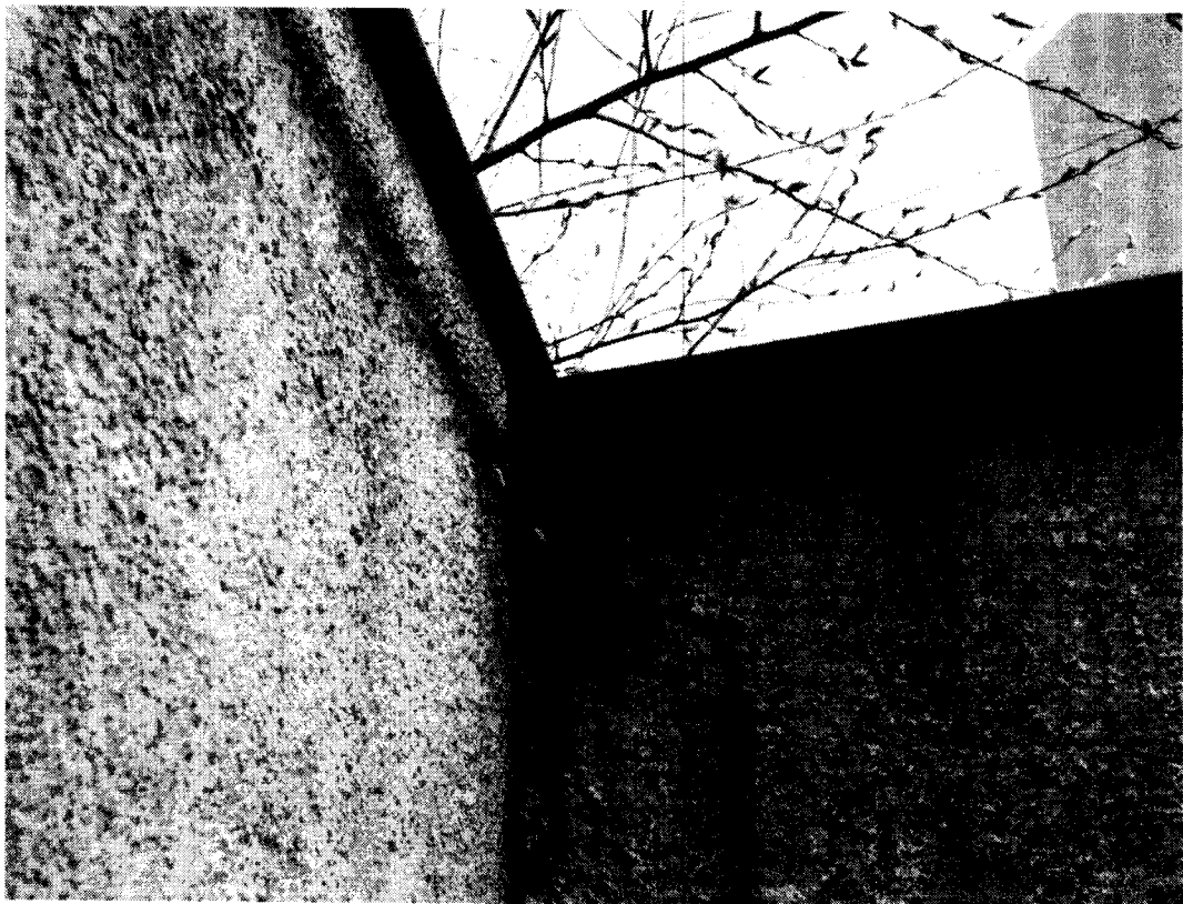
Foto.4 Pęknięcie ściany garażu od muru na granicy działki
