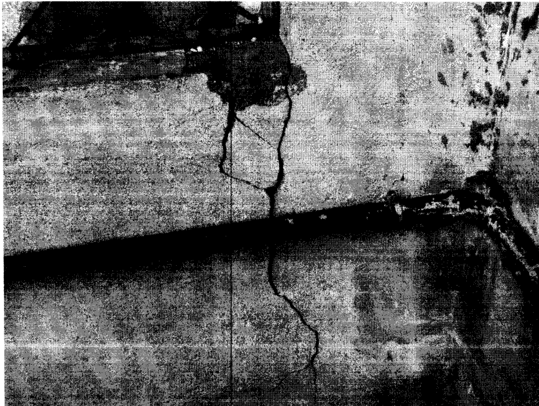
Foto.5 Pęknięcia ściany pod oknem w pomieszczeniu gospodarczym
