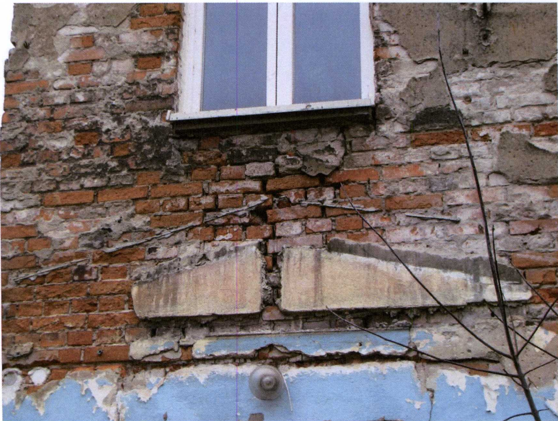
Foto.4 Pęknięcie ściany zewnętrznej
