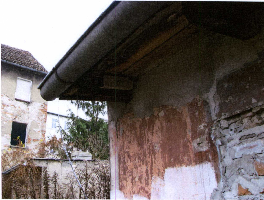
Foto.18 Spróchniały okap budynku gospodarczego
