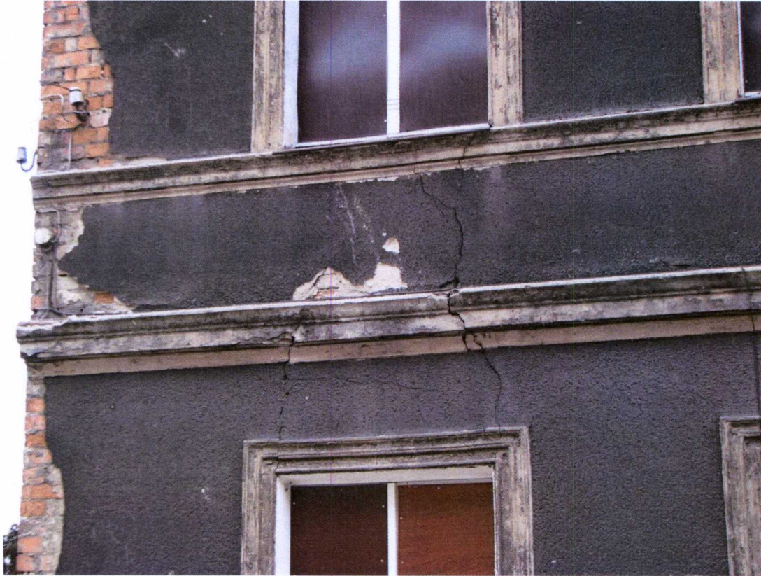
Foto.5 Pęknięcie ściany zewnętrznej
