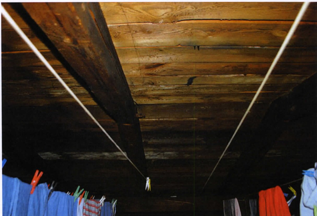
Fot. 14-16. Stan więźby dachowej budynku 2b (u góry w części adaptowanej na mieszkanie).
