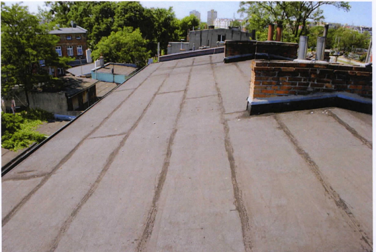
Fot. 12 i 13. Stan pokrycia dachowego i kominów (u góry na styku budynków).
