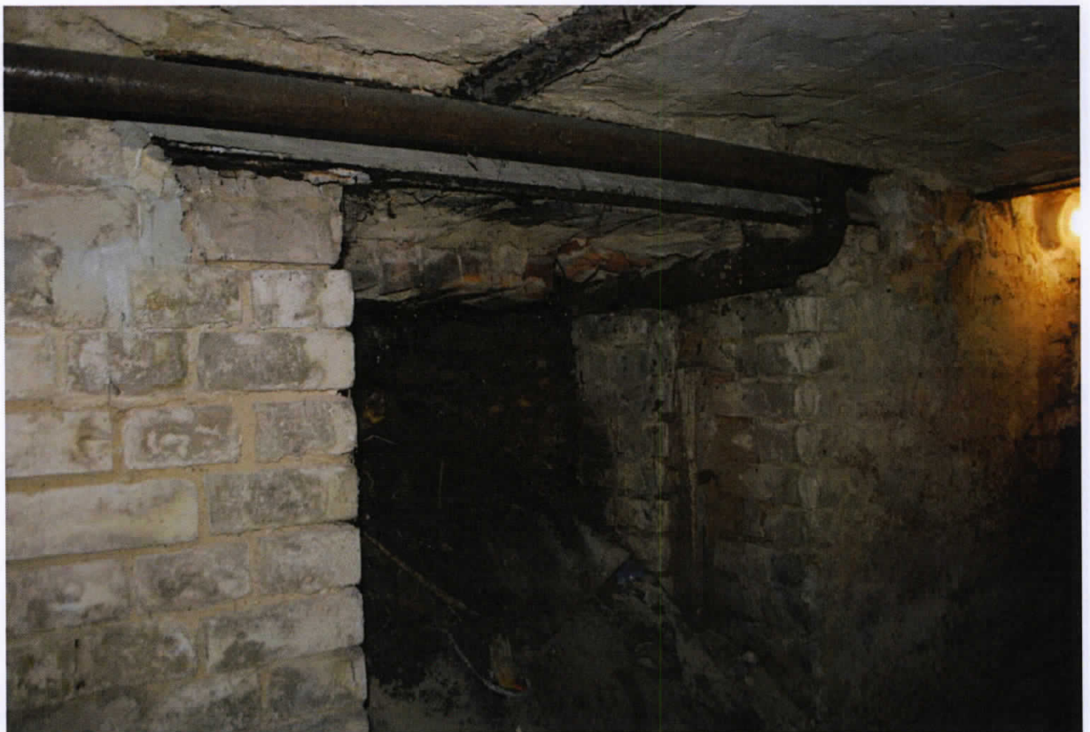
Fot. 24. Stan okienek naświetlnych piwnic budynku 2c.
