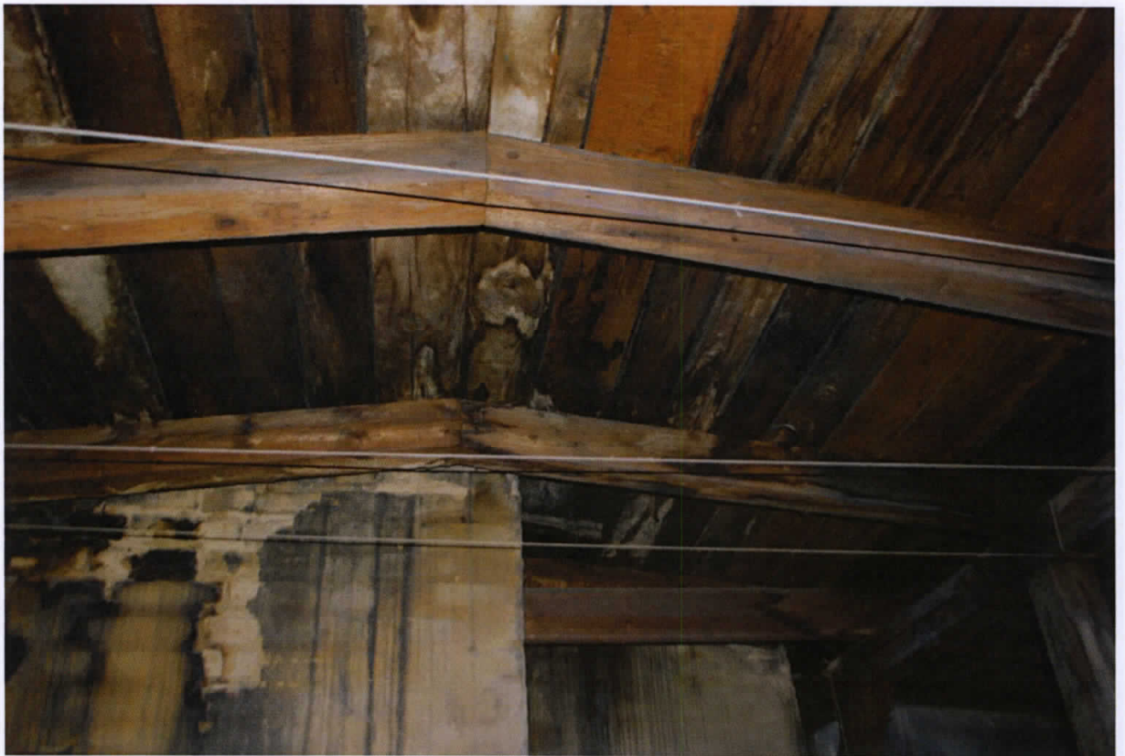
Fot. 17 i 18. Stan więźby dachowej budynku 2c.
