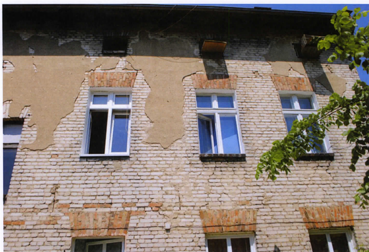
Fot. 7 i 8. Stan spękań ścian piętra budynku 2c od strony podwórza (południowej).
