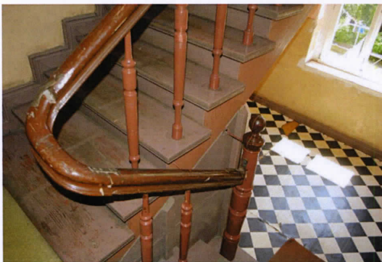
Fot. 20-22. Stan schodów.
