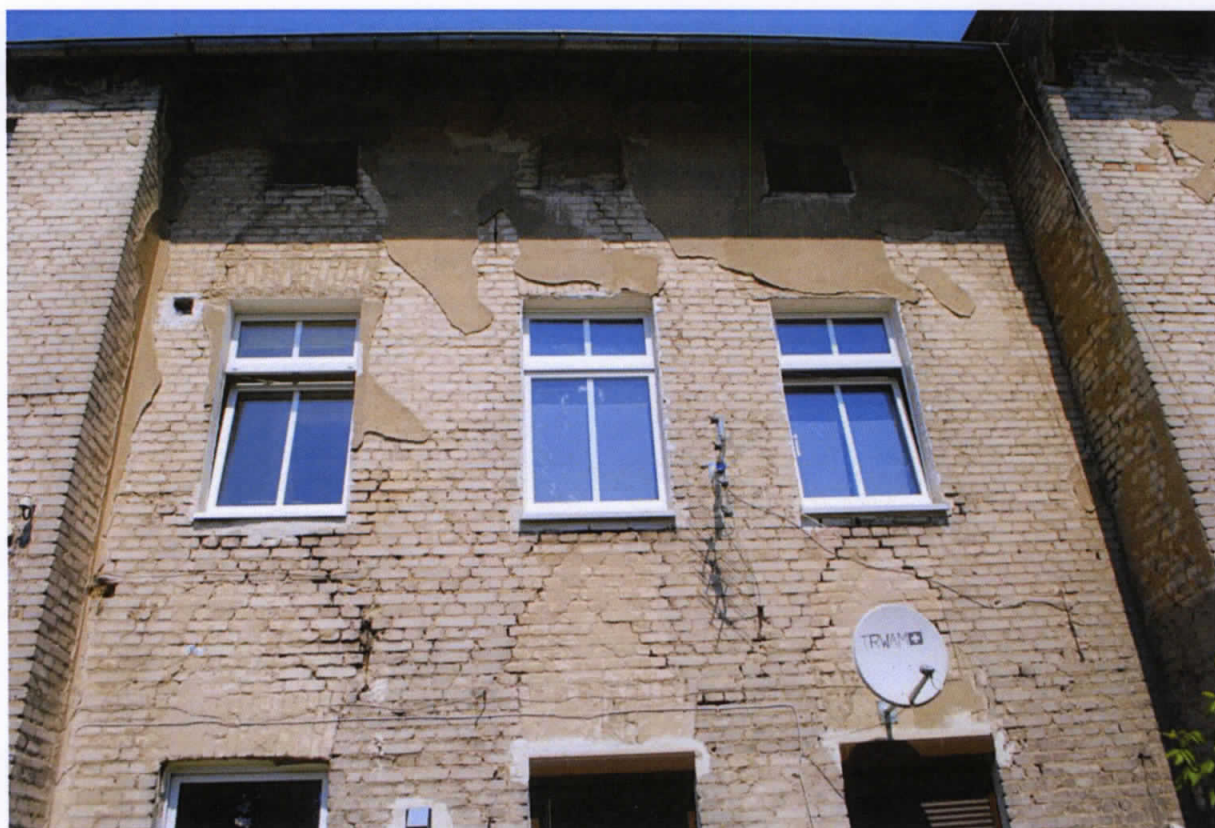
Fot. 5 i 6. Stan spękań ścian piętra budynku 2b od strony podwórza (południowej).
