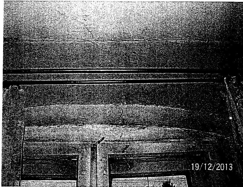
Fot.5. Widok pękniętego nadproża okiennego w mieszkaniu nr 3 od strony lokalu.
