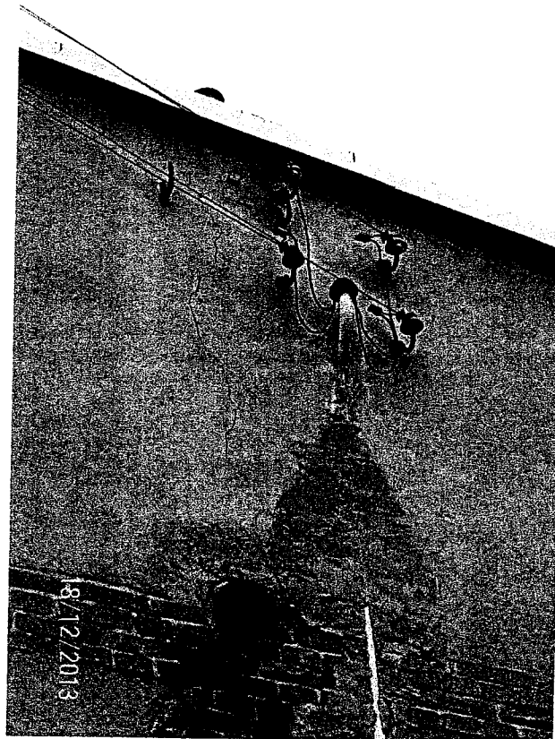
Fot.6. Pęknięcie górnego odcinka elewacji szczytowej.
