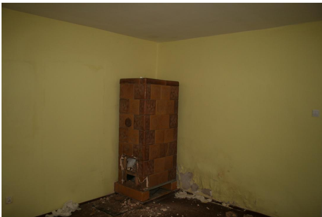
Zawilgocenia i zniszczenia wnętrza budynku mieszkalnego
