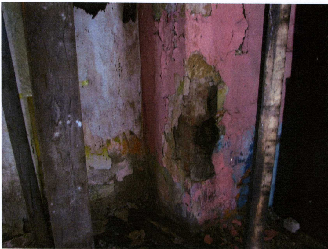
Foto.3 Komin wewnątrz pomieszczenia
