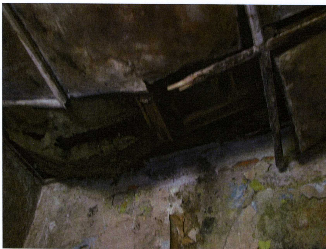
Foto.4 Zarwany strop podwieszony
