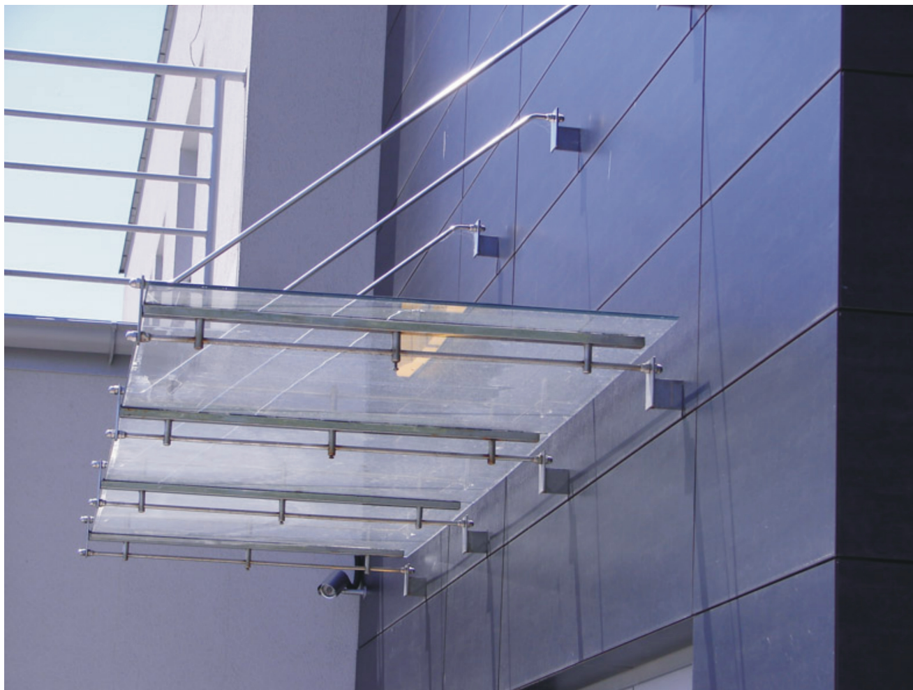
ZADASZENIE SYSTEMOWE WYKONANE W KONSTRUKCJI STALOWEJ O SZKLANYM PRZEKRYCIU (np. proponowane przez firmę Przedsiębiorstwo Usługowo Produkcyjno Handlowe Centrum Szkła – Jerzy Gad)
