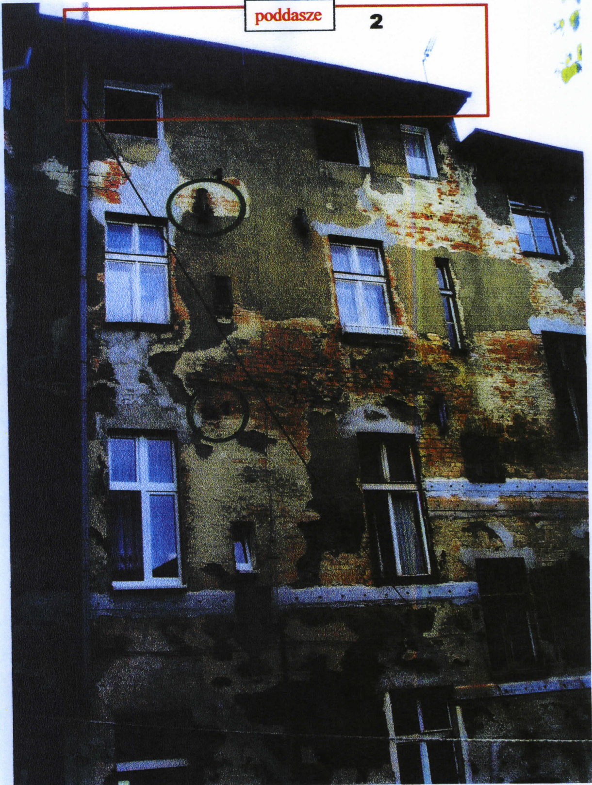
Fot.12.Ściana E. Fot. Bogdan Rudzinek
