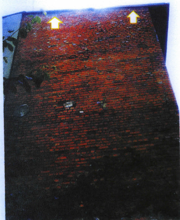
Fot.14.Ściana C. Fot. Bogdan Rudzionic
