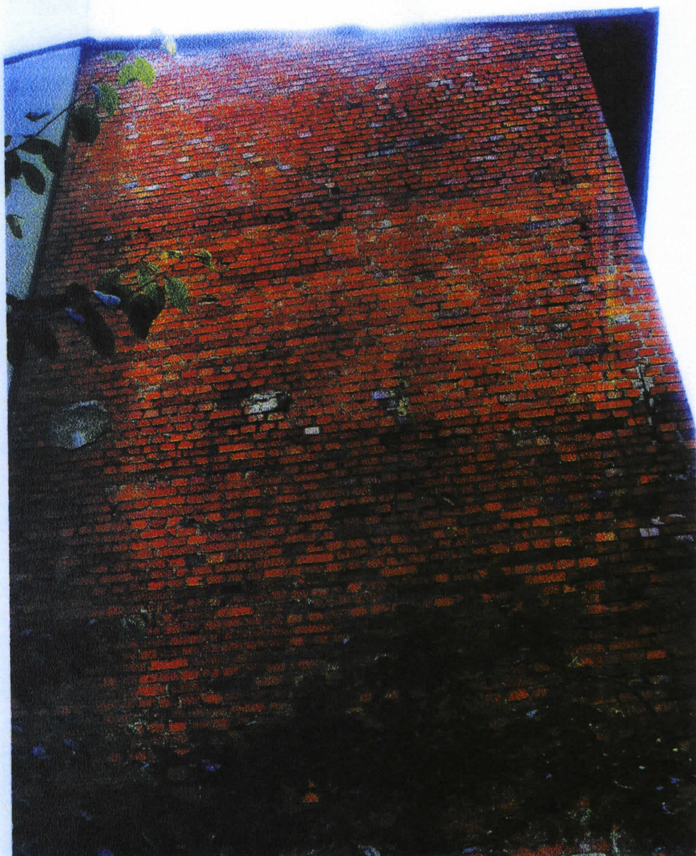
Fot.3.Ściana C. Fot. Bogdan Rudzionic
