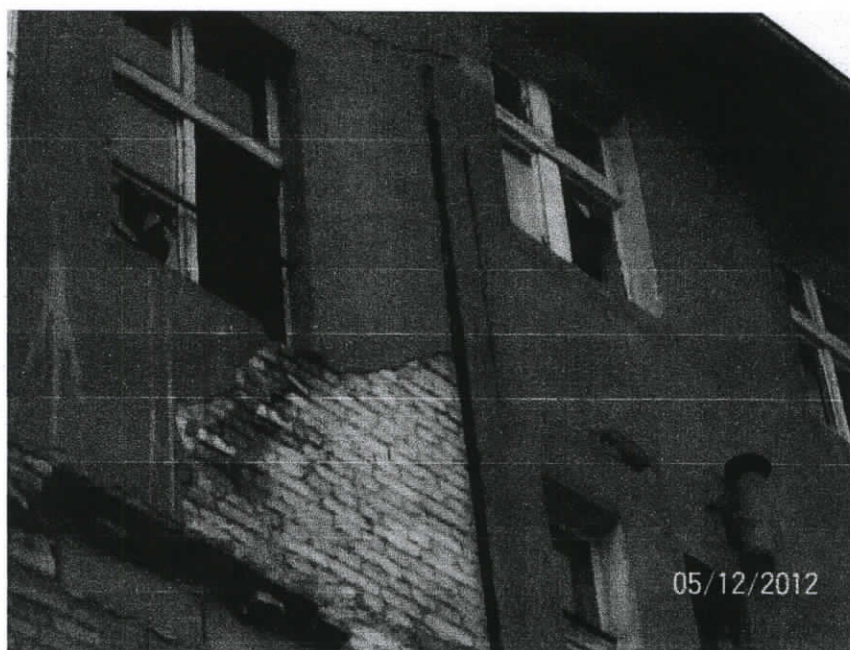
Fot.5. Fragment stalowego wzmocnienia budynku.
