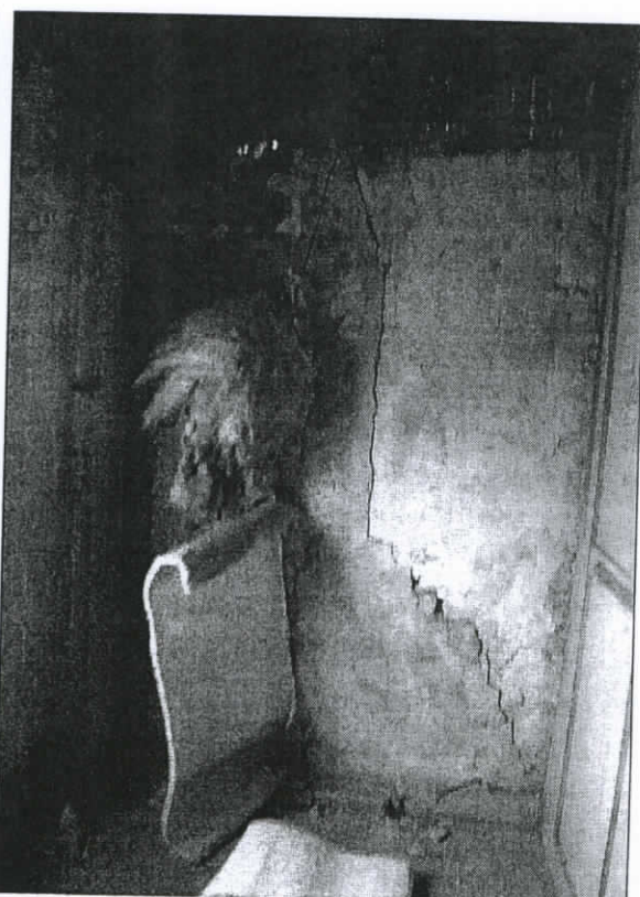
WYSUNIĘCIE ŚCIANY NA ZEWNĄTRZ W POZIOMIE IV WIDAĆ OTWÓR PO WYPADNIĘCIU CEGIEŁ GZYMSU ORAZ NIEZAKOTWIONY KONIEC RYGLA ŚCIANKI KOLANKOWEJ
