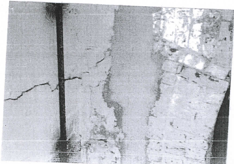
NR 6 PIKNICA - SPĘKANE NADPROŻE I SUFIT
