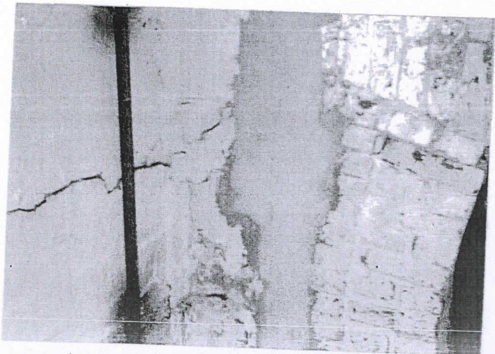
NR6 PINNICA - SĘKASNE NADPROŻE I SUFIT
