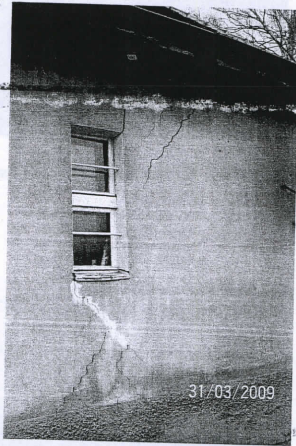
Fot. 5. Pęknięcia elewacji południowej.
