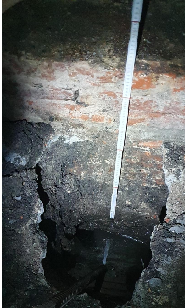
Fot. 6. Widok ubytków materiału cegieł i zaprawy oraz szczelina szerokości 8 cm w ścianie fundamentowej zachodniej wykonanej odkrywki nr 1, poziom wody gruntowej swobodny około 0,40 m poniżej poziomu posadzki. Fragment ściany fundamentowej ceglanej w dobrym stanie.
