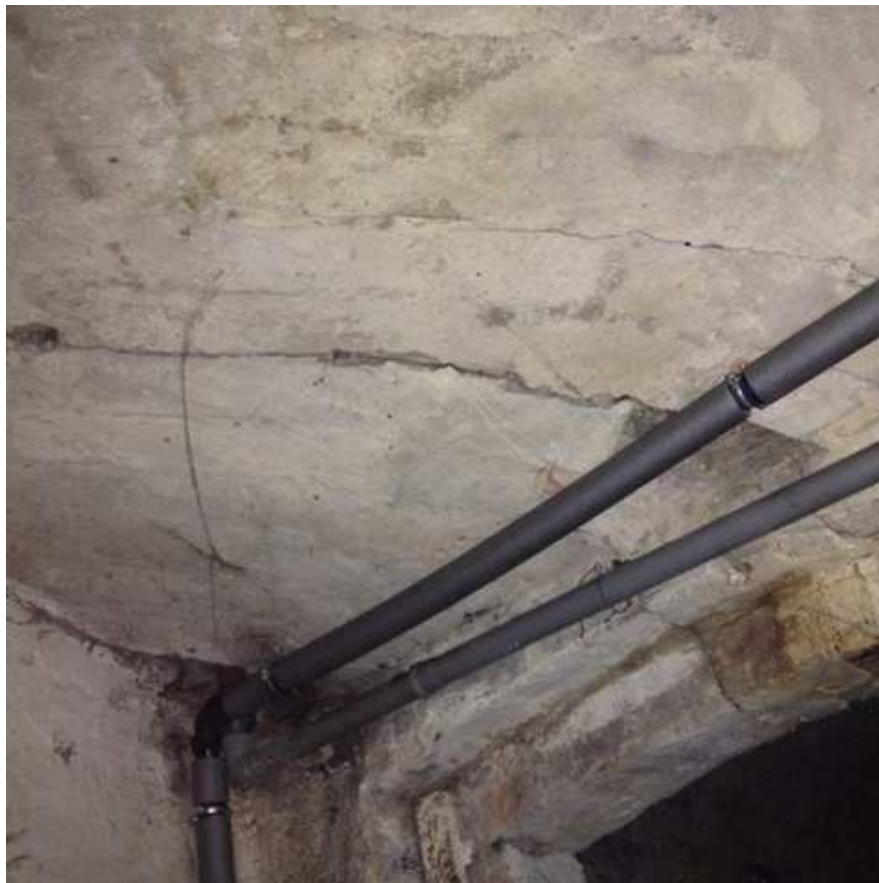
szpara w stropie nad piwnicą i spękanie nadproże w budynku przy ul. Grodzkiej - 6
