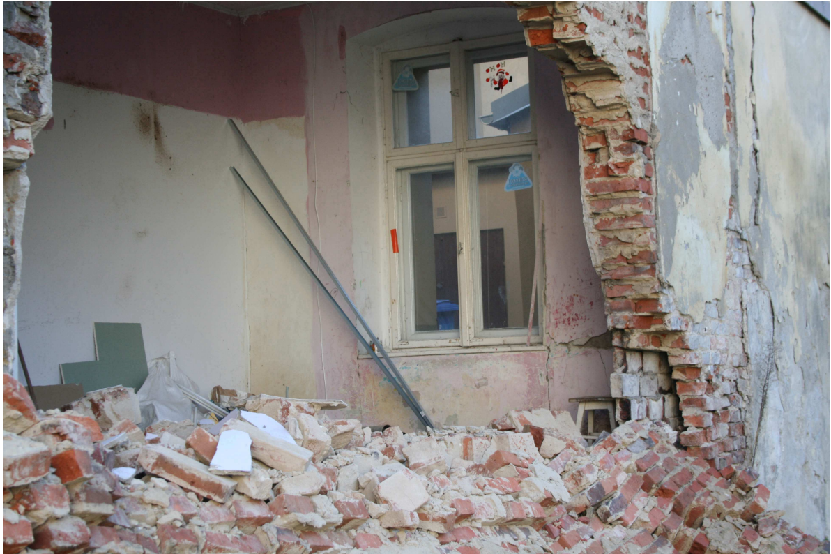
Rys. 12 – Widok sklepienia z prawej strony wraz z osłabieniem przekroju ściany pustką.
