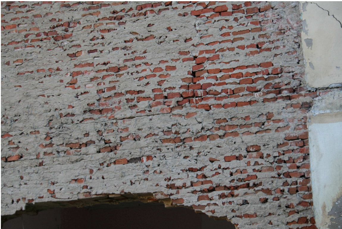
Rys.15 – Powstały łuk i spękana nad nim ściana.
