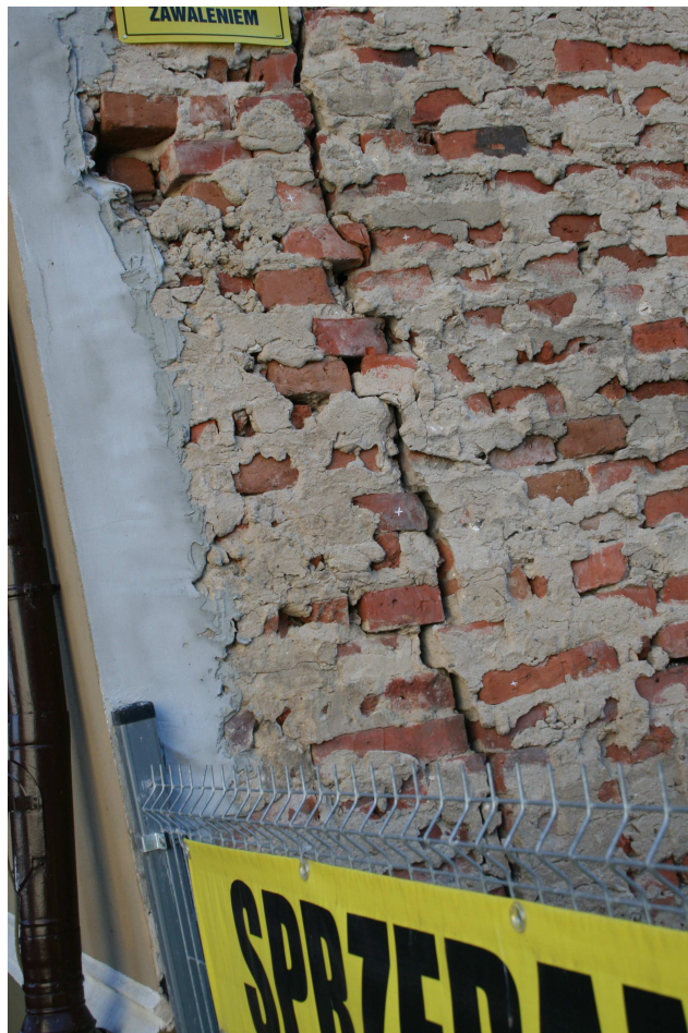
Rys.17 – Odspojona ściana szczytowa od ściany przy ul. Grodzkiej.
