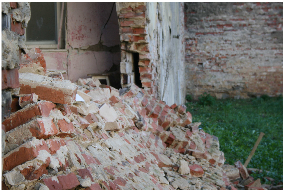
Rys.13 – Pustka w ścianie o rozwarłości – 20cm (38-6-12).
