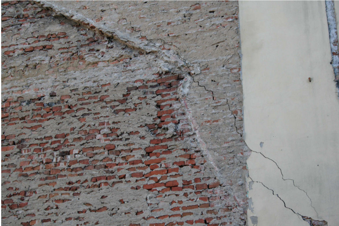
Rys.14 – Ściana szczytowa – spękana.
