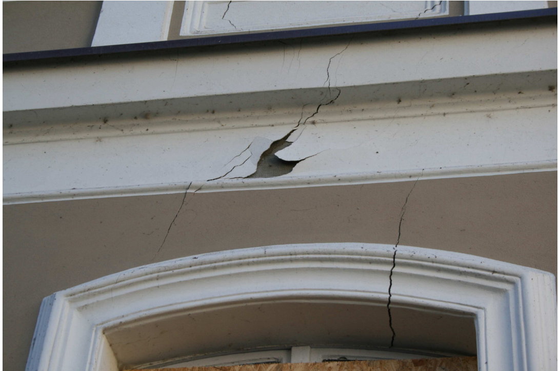
Rys.16 – Pęknięte nadproże w ścianie przy ul. Grodzkiej.
