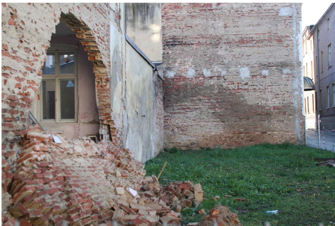
Rys.1 – Widok uszkodzonej ściany szczytowej
