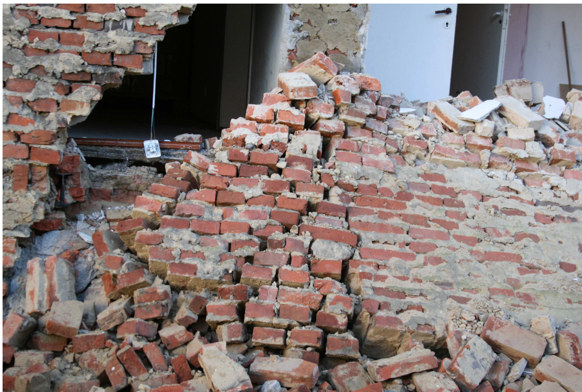
Rys.11 – Widok sklepienia z lewej strony wraz z odspojoną ścianą działową nośną.
