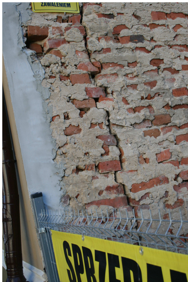
Rys.19 – Odspojona ściana szczytowa od ściany przy ul. Grodzkiej.
