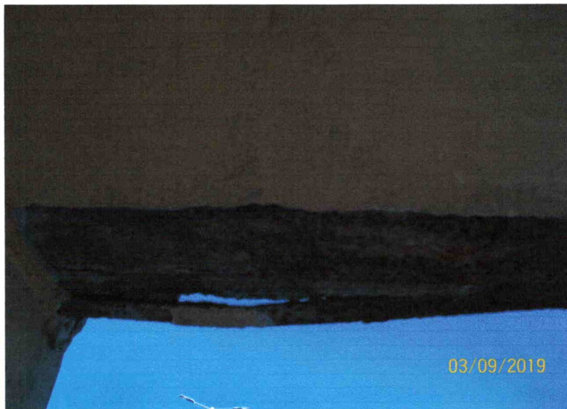
Fot.5,6. Uszkodzony płaskownik na krawędzi północnej balkonu.
