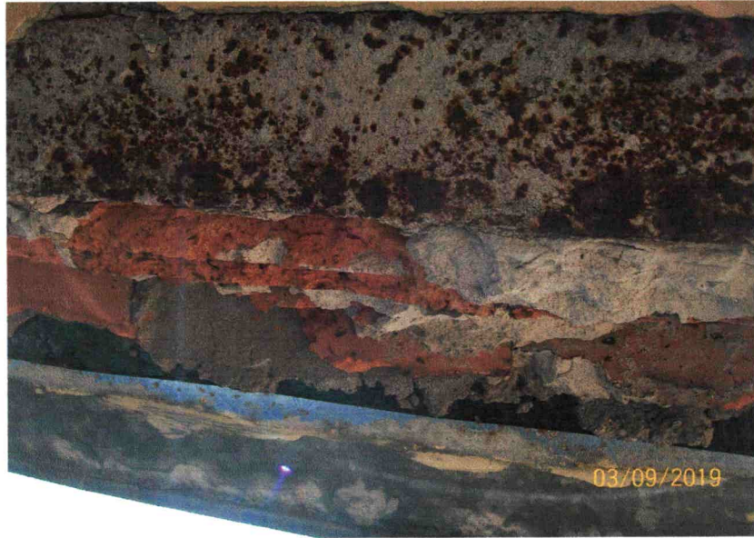
Fot.3,4. Ubytki płaskownika podpierającego cegły na południowej krawędzi balkonu II piętra.
