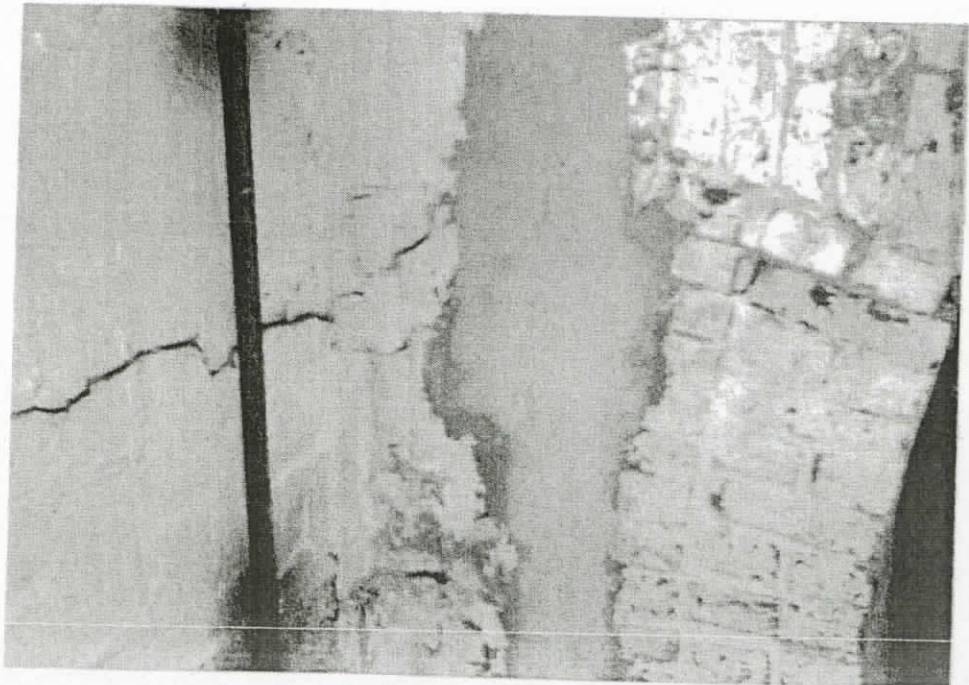
NR 6 PŁYNNICA - SPĘKANE NADPROŻE I SUFIT
