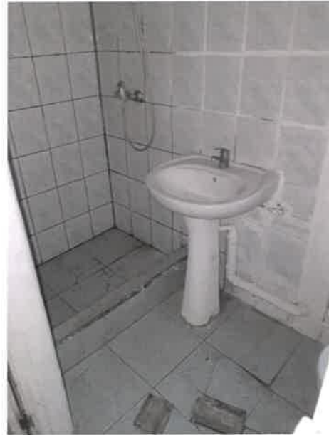
Fot. 5 łazienka – widok zarwanej podłogi
