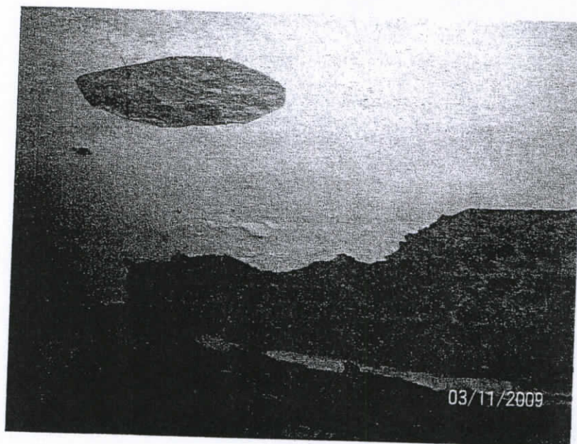
Fot. 3, 4. Zniszczone tynki na powierzchni stropów i ścian ceglanych w piwnicach.
