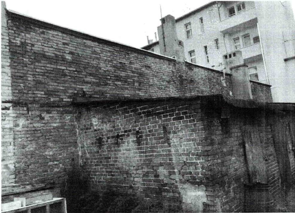
fot. nr 3 Widok budynku przewidzianego do rozbiórki od strony działki nr 79, widoczne zabudowania gospodarcze na terenie działki nr 79 sąsiadujące z budynkiem przewidzianym do rozbiórki.
