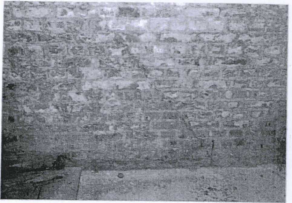
SPEKANA ŚCIANA NR 9
