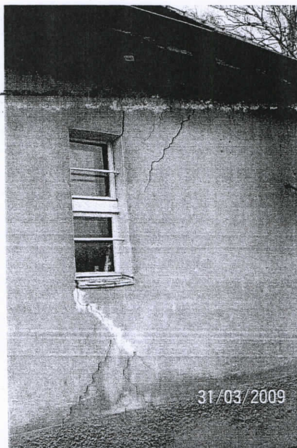
Fot. 5. Pęknięcia elewacji południowej.
