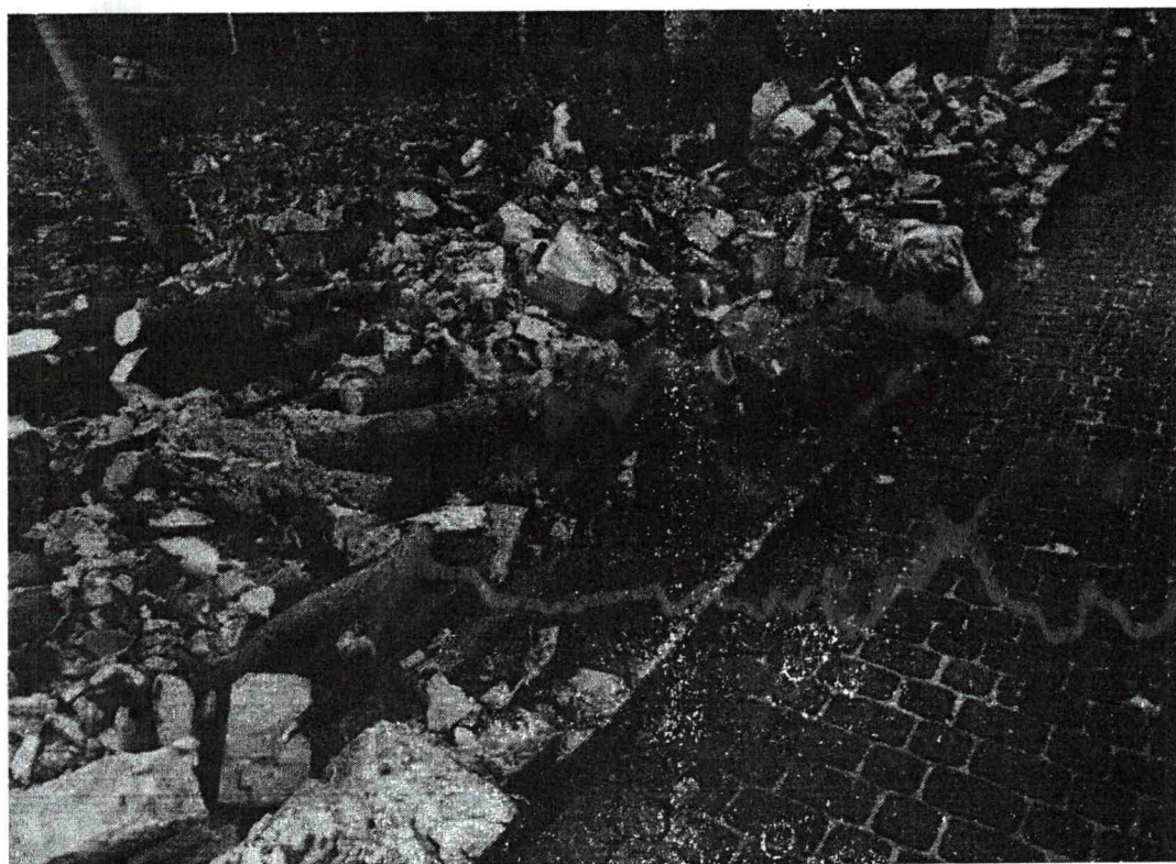
fot. nr 2 Pozostałości ogrodzenia po przewróceniu.
