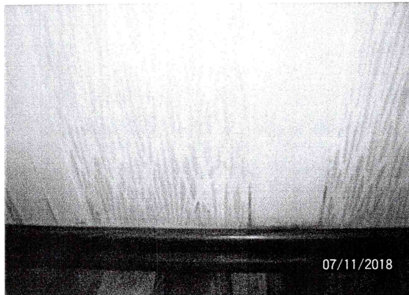
Fot.5. Zarodniki grzybów pleśniowych na powierzchni ściany zewnętrznej.
