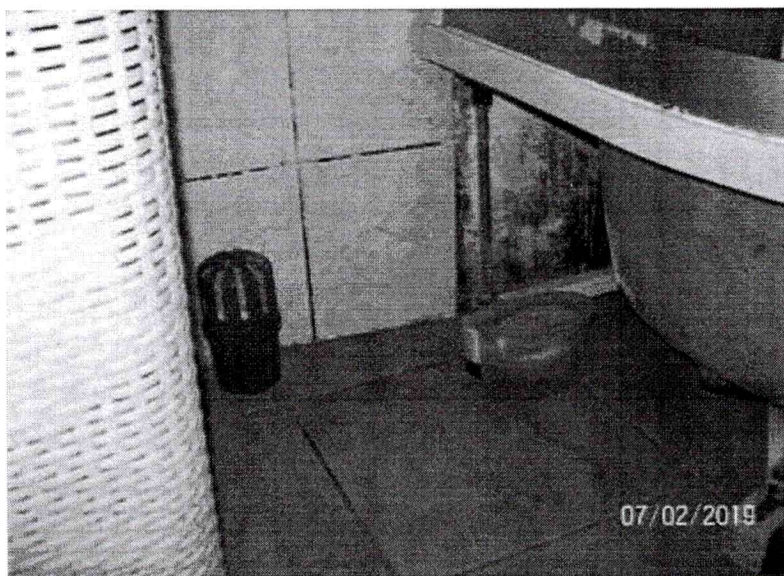
Fot.1. Ściana zewnętrzna łazienki porażona przez korozję biologiczną.
