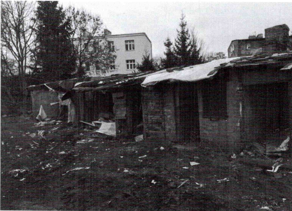
fot. nr 4 Widok budynku sąsiedniego na działce 45/4 – budynek po awarii w zakresie zadaszzenia .
