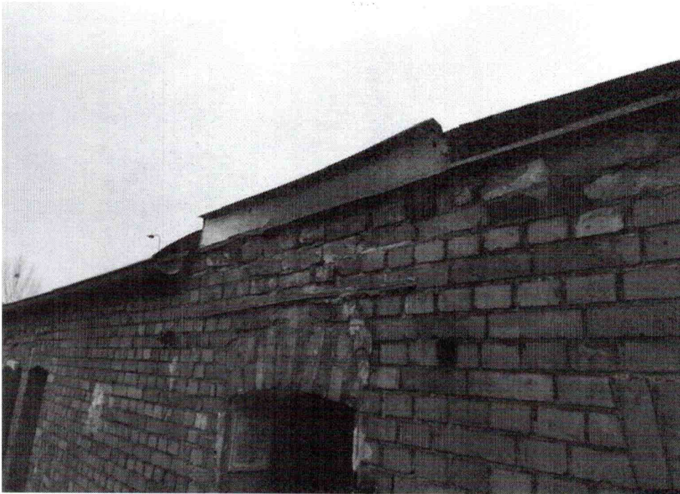
fot. nr 3 Ubytki muru oraz uszkodzenia poszycia dachu budynku przewidzianego do rozbiórki.
