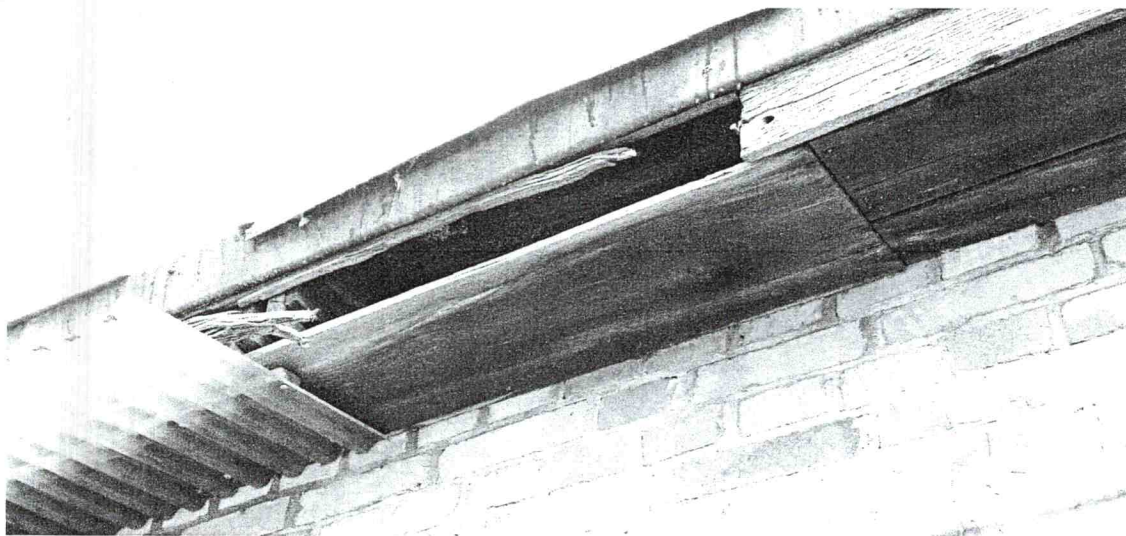
Fot. 6. Fragment uszkodzonej drewnianej obróbki dachu.
