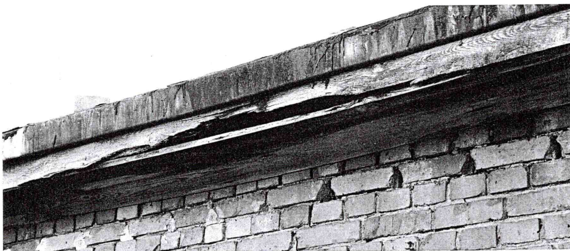
Fot. 7. Fragment uszkodzonej drewnianej obróbki dachu.
