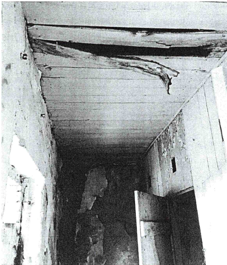
Fot. 17. Jedno z pomieszczeń we wnętrzu budynku z uszkodzonym stropem.
