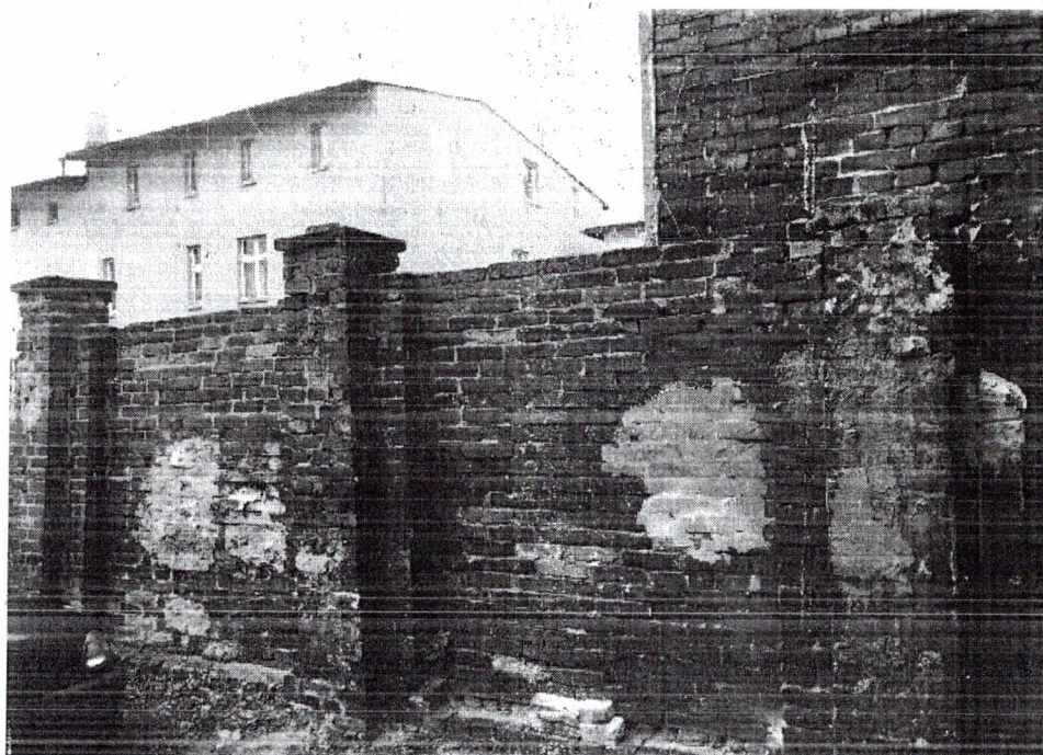
fot. nr 2 Fragment ogrodzenia sąsiadujący z budynkiem Zduny 19 – rozebrać bez naruszenia budynku.
