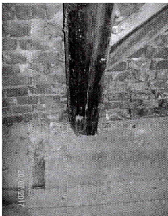
Fot. 4,5. Pokryta sadzą konstrukcja murowa i elementy drewniane.
