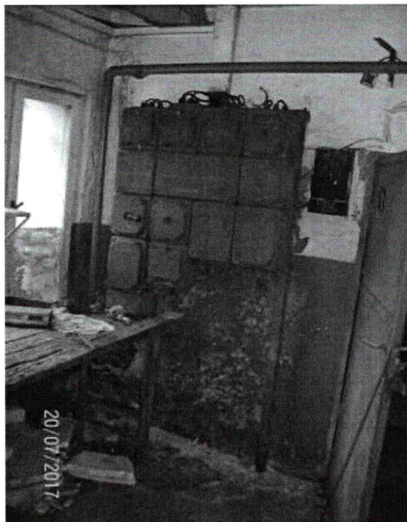
Fot.10. Zniszczona i zdekompletowana rozdzielnia elektryczna.
