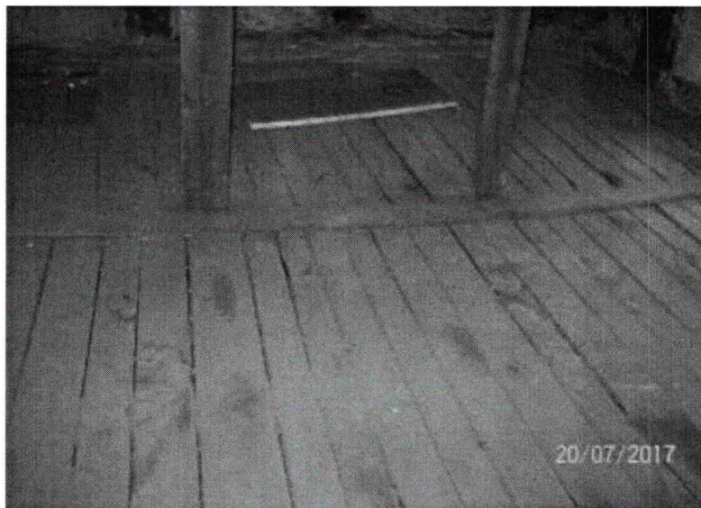
Fot.2. Ugięta podłoga na I piętrze wschodniej części budynku piętrowego.
