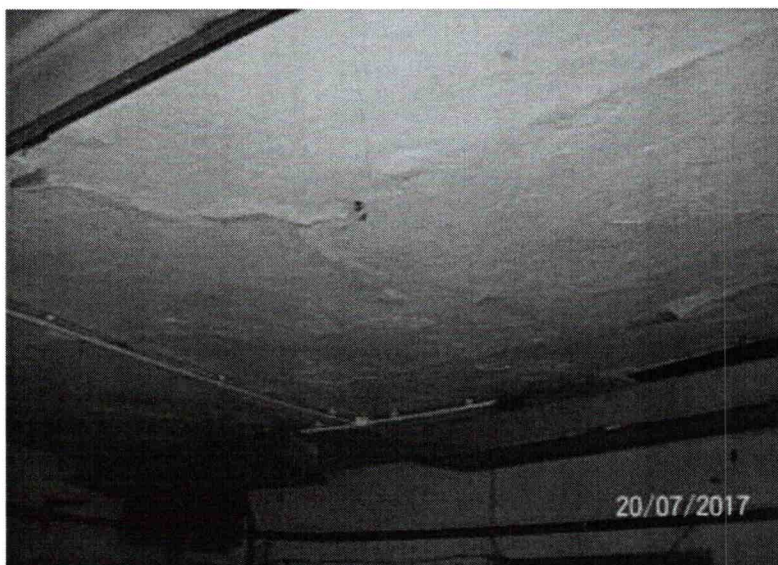
Fot.3. Obniżony strop drewniany w pomieszczeniu parteru.
