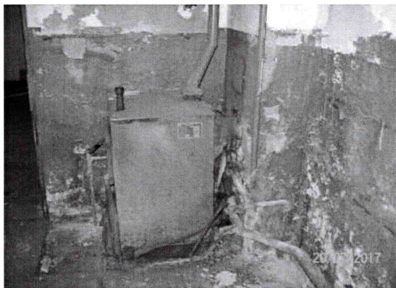
Fot.8. Fragment parteru pod spalonym pomieszczeniem na I piętrze.
