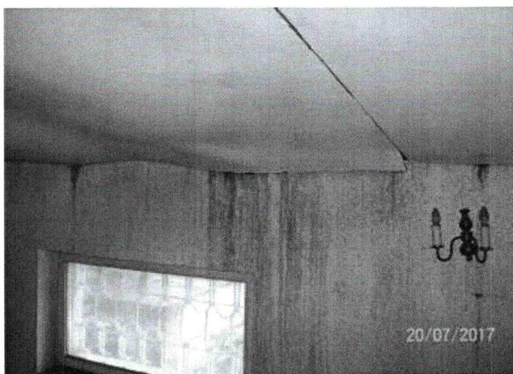
Fot.7. Zacieki na ścianach i wypaczona podsufitka na I piętrze budynku.
