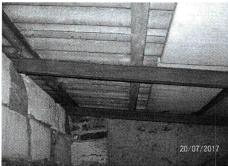
Fot.6 Zdekompletowany sufit w spalonym pomieszczeniu.
