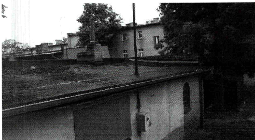
fot. nr 2 Widok obiektu od strony ściany w osi 4, widoczne ugięcie dachu budynku w zakresie osi D-E.
