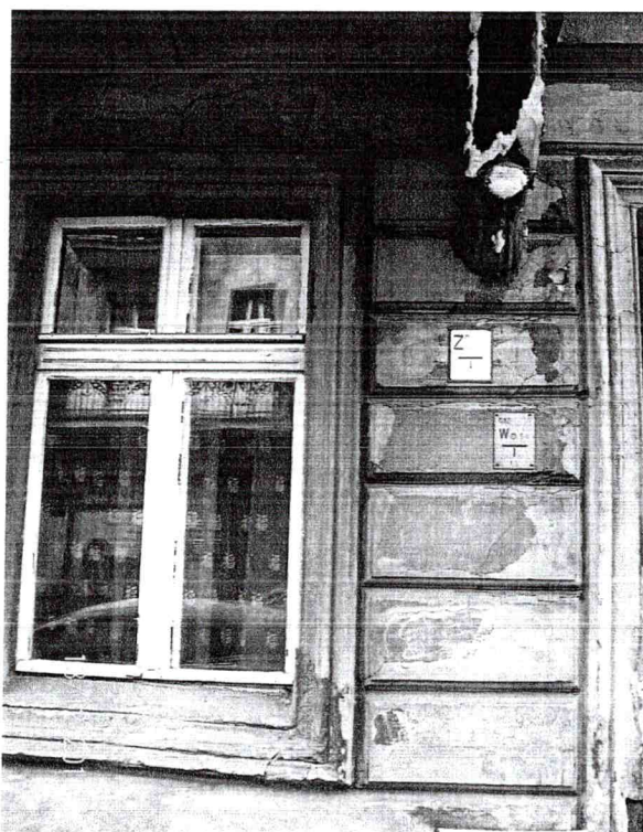
Fot.21. Uszkodzone nadproże, zniszczony wspornik i opuszczony parapet okienny na elewacji frontowej.
