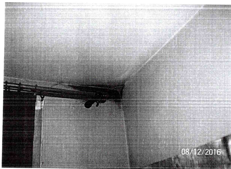
Fot.7. Kolonie grzybów pleśniowych na powierzchni ściany zewnętrznej od strony ulicy.
