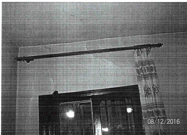
Fot. 16. Spękana ściana zewnętrzna i obniżona ościeżnica drzwi wyjściowych na balkon.
