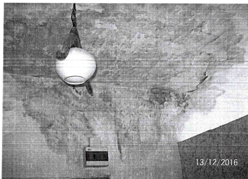
Fot.13. Zalany strop w mieszkaniu nr 2a.
