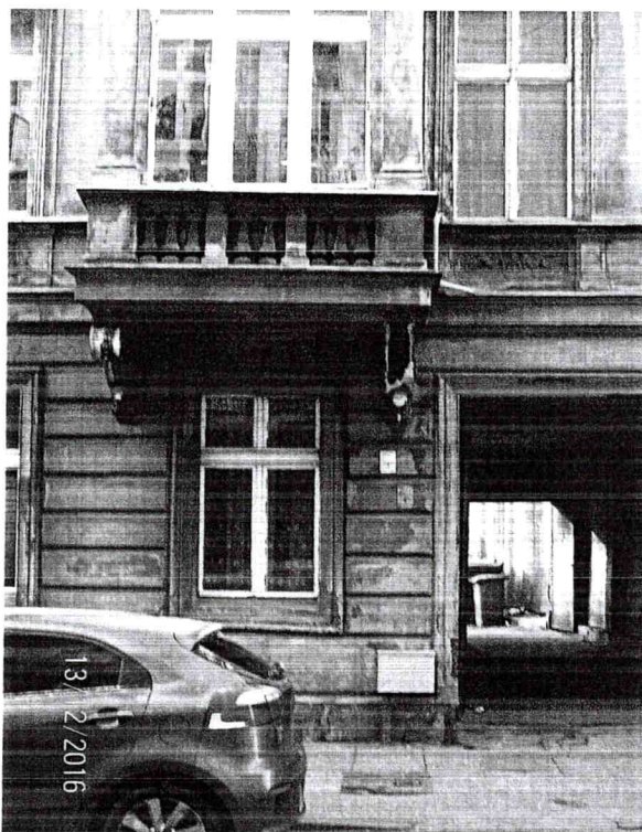
Fot.20. Miejsce lokalnego osiadania budynku widoczne na elewacji frontowej.
