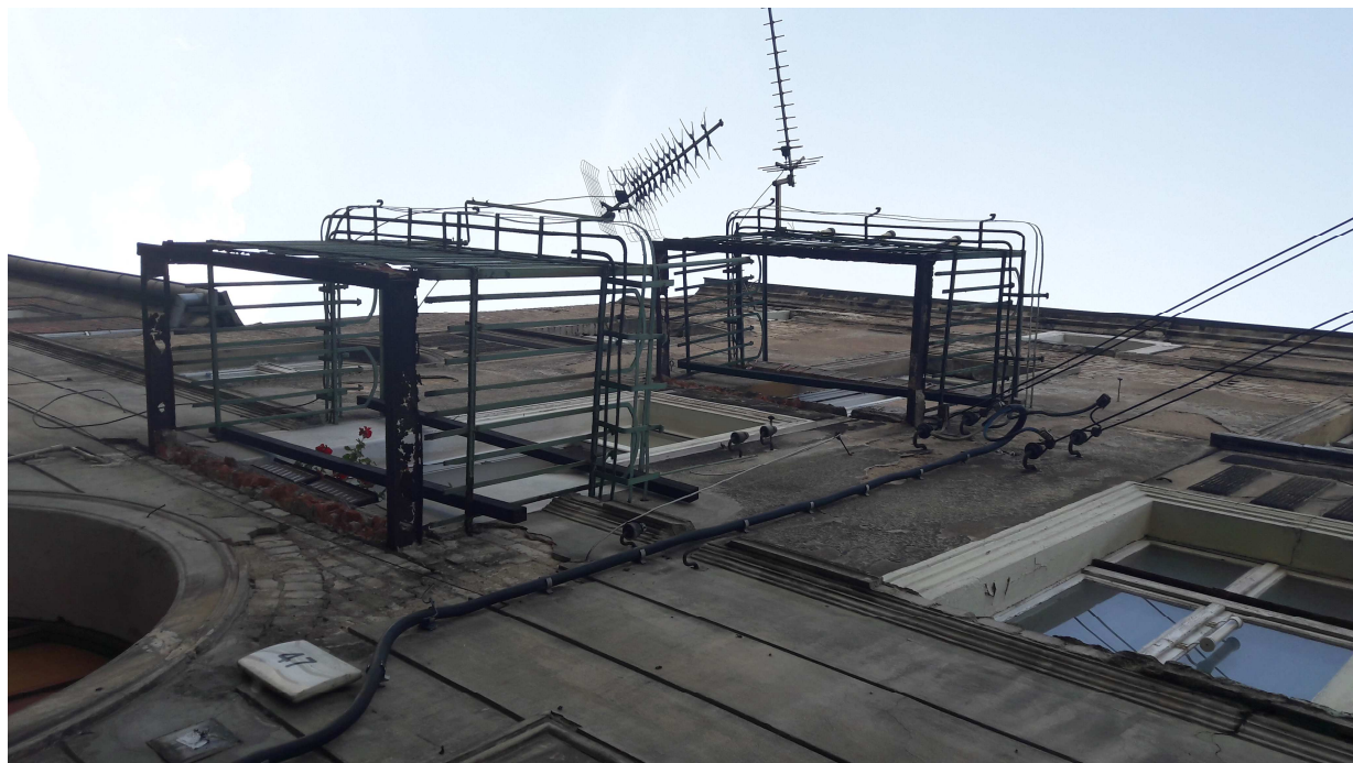
Fot. 03 Stan konstrukcji balkonów widok 1
