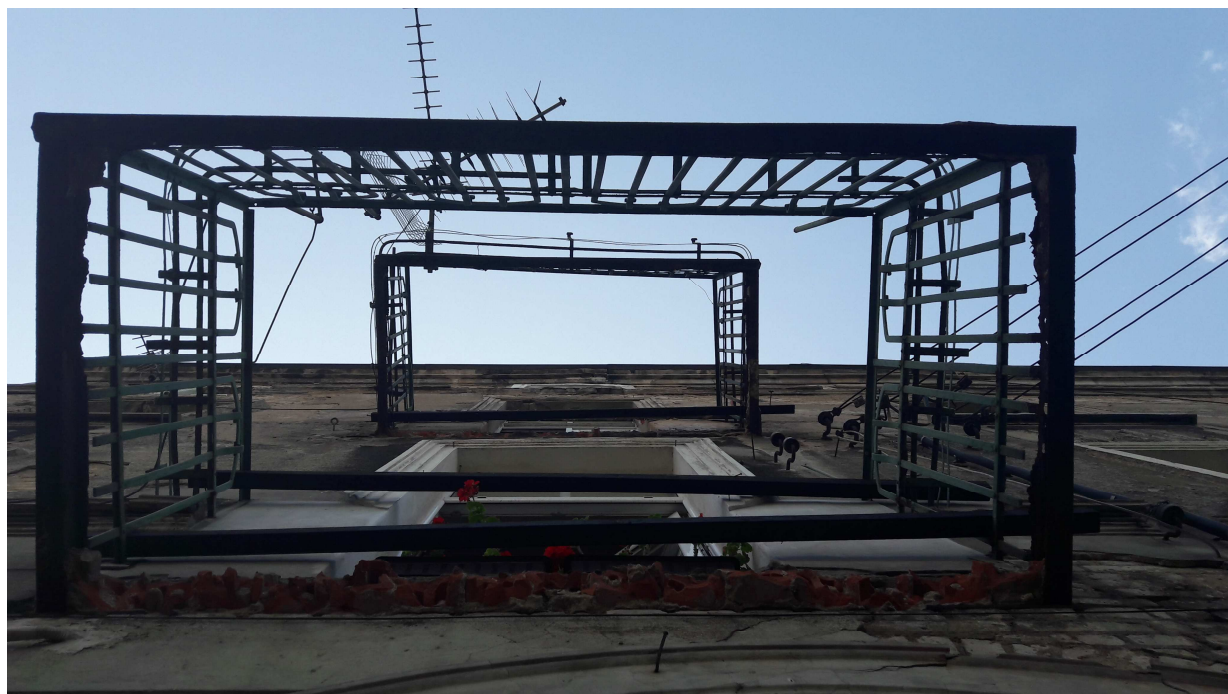
Fot. 04 Stan konstrukcji balkonów widok 2
