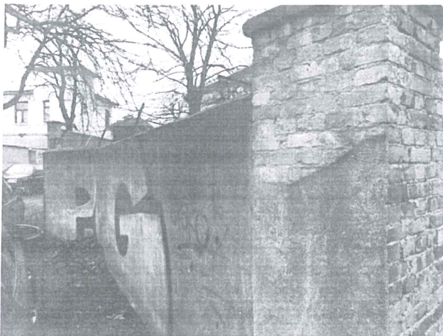
fot. nr 9 Ogrodzenie murowane w zachodniej części działki nr 78 obr. 82 – przewidziane do rozbiórki wraz z fundamentami. Fundamenty ogrodzenia rozebrać bez naruszenia fundamentów ogrodzenia sąsiedniego.
