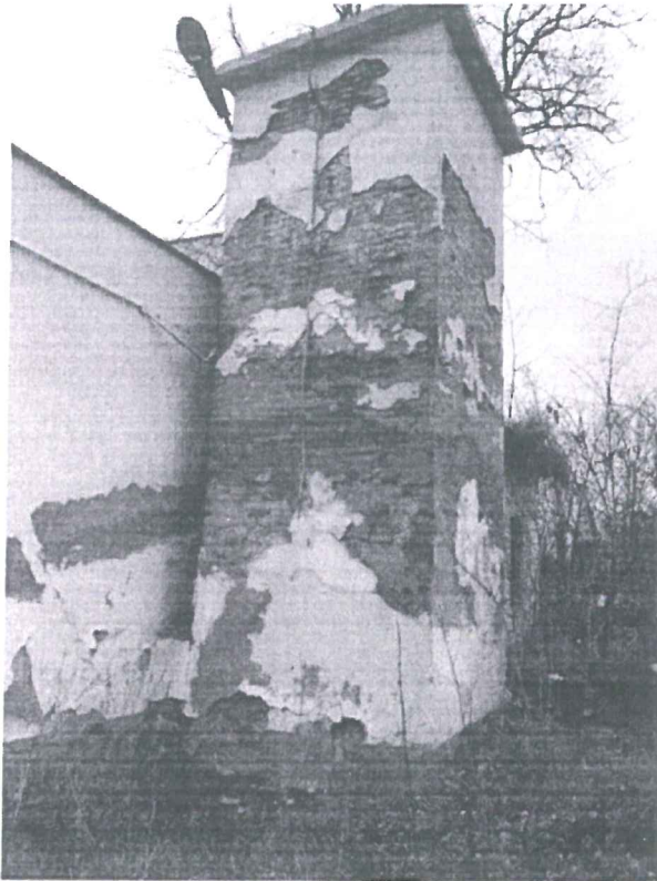
fot. nr 3 Widok komina przewidzianego do rozbiórki – liczne ubytki tynku, widoczne spękania muru w dolnej części obiektu.
